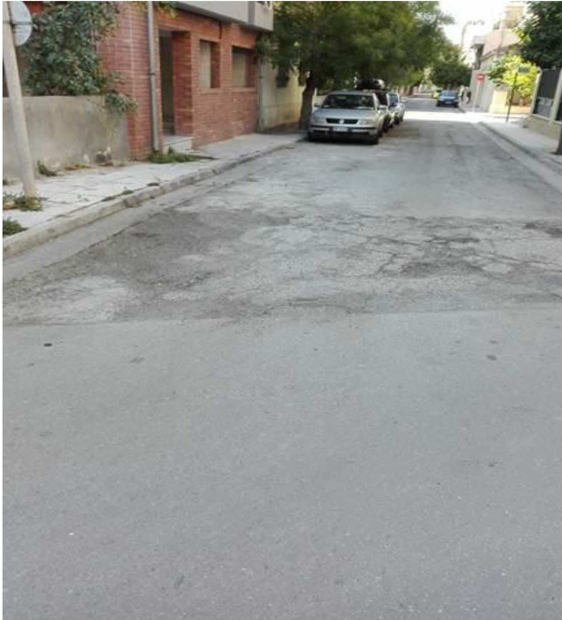
Εικ.115: Εδώ παρατηρείται μια κακοτεχνία του δρόμου που προκλήθηκε από τα νερά που μαζεύονταν εκεί, καθώς και από την παλαιότητα του δρόμου και την κακή κατασκευή. Ο δρόμος αυτός είναι η Αβέρωφ.
