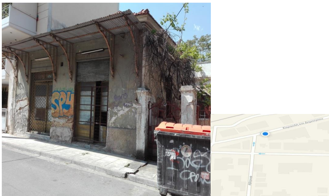
Εικ.4: Το εγκαταλελειμμένο κτίριο αυτής της εικόνας βρίσκεται επί της οδού Καραολή και Δημητρίου 37. Φαίνεται ότι βρίσκεται σε χάλια κατάσταση. Ένας από τους κινδύνους αυτού του κτιρίου είναι η κατάρρευση που έχει μεγαλύτερη πιθανότητα από την Εικόνα 3 . Οι υπόλοιποι κίνδυνοι που έχει είναι ίδιοι με της Εικόνας 3 .
