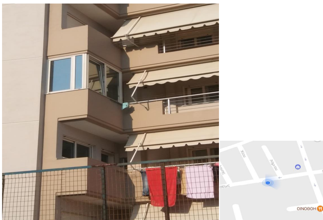
Εικ.22: Στην φωτογραφία βλέπετε μια αυθαίρετη κατασκευή στον εξώστη που τον έχει κλείσει όλον με τζάμι για να τον χρησιμοποιήσει για κύρια χρήση. Αυτή η κατασκευή είναι επί της οδού Μεταμορφώσεως.
