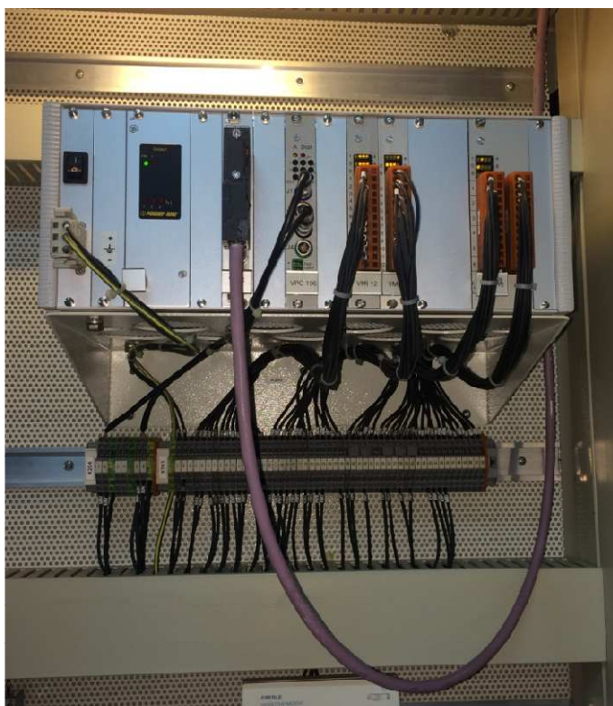
Εικόνα 39 Σύστημα SEPCOS εγκατεστημένο σε τροφοδοτικό φορείο (feeder –εσωτερικά-σταθερό μέρος)
