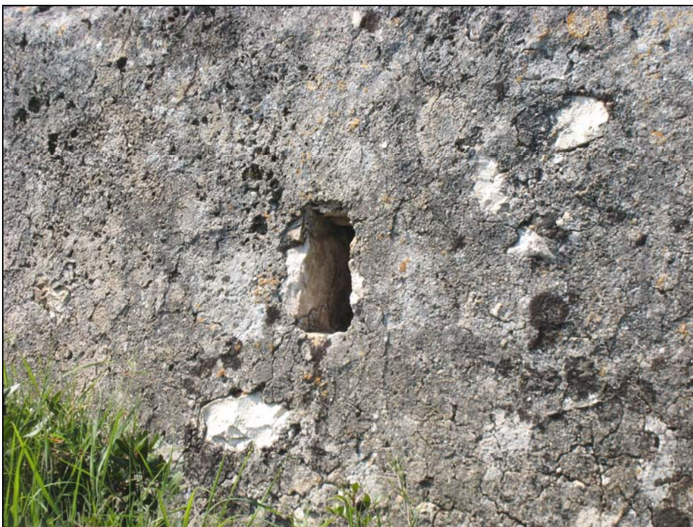
Εικ. 62 : Η ίδια ως άνω οπή, εξωτερικά. Διακρίνεται η στρώση επιχρίσματος στην επιφάνεια του τοίχου.
