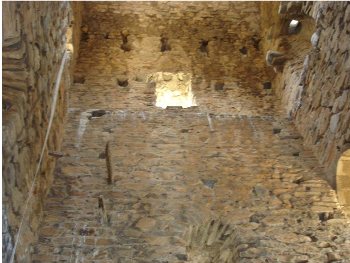
ΦΩΤΟΓΡΑΦΙΑ 16 Βορειοδυτική εσωτερική όψη βίγλας κουτουμουλά Μεσαίος και άνω εσωτερικός χώρος Παράθυρο στον άνω χώρο και άποψη της θολωτής οροφής
