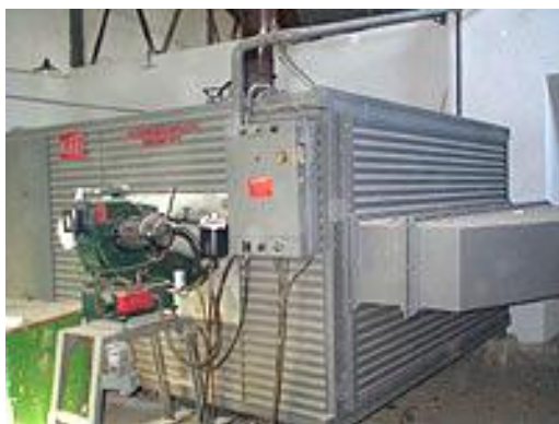
Εικόνα 147: Αερολέβητας νέων ξηραντηρίων.
