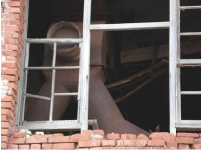
Εικόνα 22: Αγωγός διοχέτευσης θερμού αέρα.
