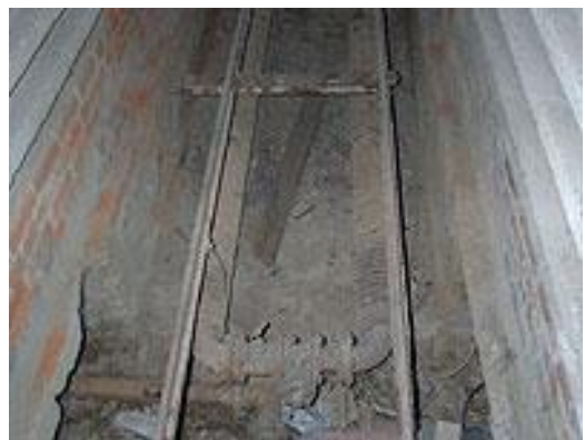
Εικόνα 146: Πτερυγιοφόροι σωλήνες θέρμανσης θαλάμων παλιών ξηραντηρίων.
