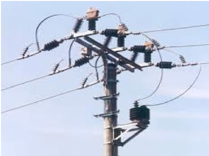
Εικόνα 6: Μη τηλεχειριζόμενος τριπολικός διακόπτης φορτίου ελαίου εξωτερικού χώρου
