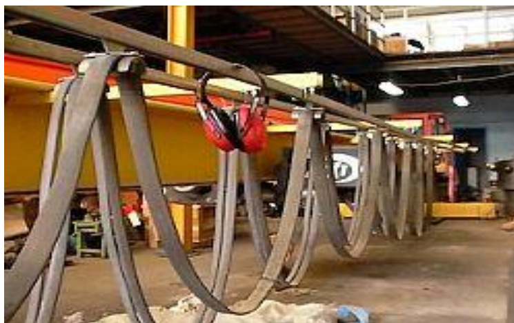
Εικόνα 109: Καλωδίωση σε ραουλοφόρο σύστημα
