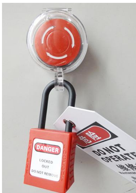
Εικόνα 17: Τύπος emergency διακόπτη με lock out-tag out
