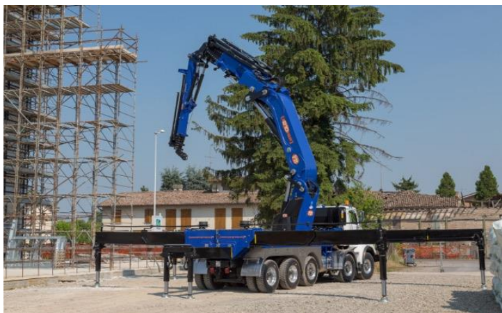
Εικόνα 5.13 - Γερανός φόρτωσης PM
