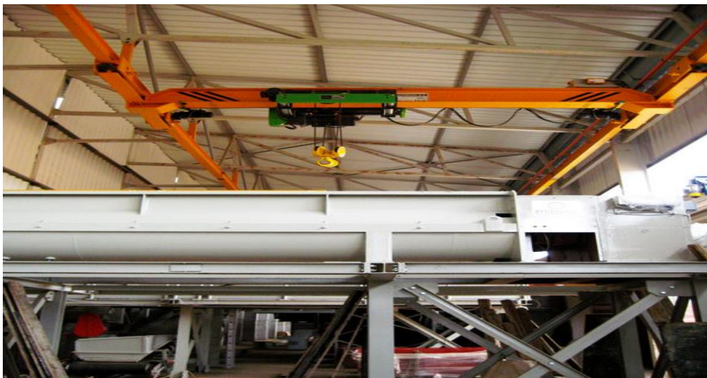
Εικόνα 5.2 – Γερανογέφυρα μονού φορέα με κρεμαστό βαρούλκοφορείο
