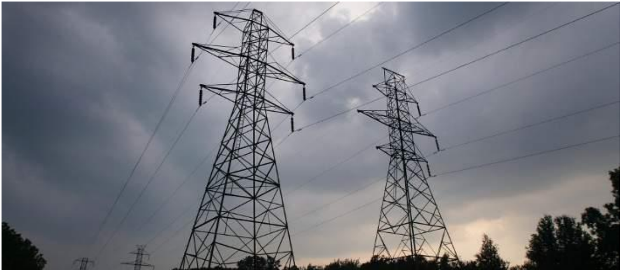
Εικόνα 1-2. Στην παραπάνω εικόνα βλέπουμε ένα σύστημα μεταφοράς υψηλής τάσης (Υ.Τ)
