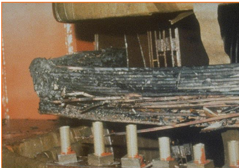
Εικόνα 2-9. Αυτός είναι ο μετασχηματιστής (500/22kV 1200MVA) που υπέστη θερμική ζημιά σε τύλιγμα χαμηλής τάσης.
