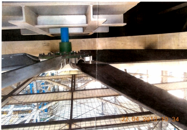
Εικόνα 4.3: Γενική άποψη ενός ανεμιστήρα
