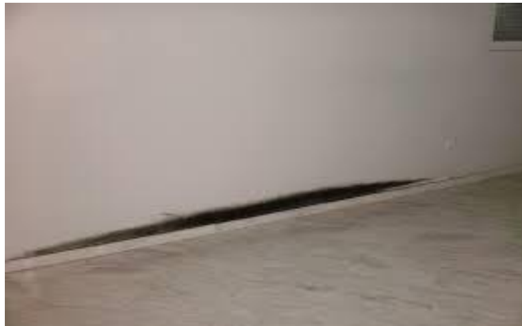
Σχήμα 2.2: Σημάδια από υγρασία συμπύκνωσης, που είναι αποτέλεσμα ελλιπούς θερμομόνωσης του στοιχείου αυτού. Το σημείο αυτό αποτελεί θερμογέφυρα.
