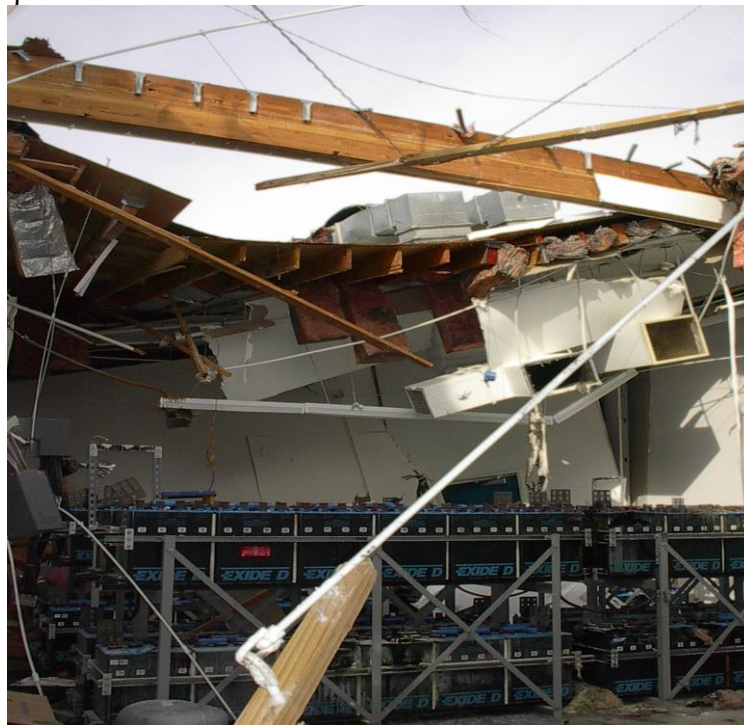
Σχήμα 28 : Έκρηξη σε Battery Room στην Καλιφόρνια
