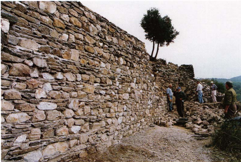
Τοιχοποιία στο βυζαντινό κάστρο της Μυγδονικής Ρεντίνας (Πηγή:Ν.Κ.Μουτσόπουλος , Ρεντίνα 2 ( το βυζαντινό κάστρο της μυγδονικής ρεντίνας , η οχύρωση και η ύδρευση του οικισμού , Τεχνικό επιμελητήριο Ελλάδας )
