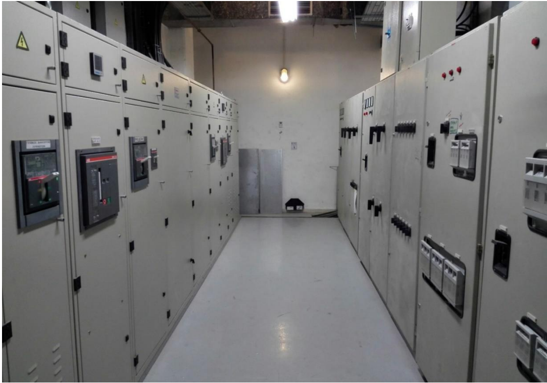
Εικόνα 3.8: Πίνακες Χαμηλής Τάσης (Τύπου Πεδίων)
