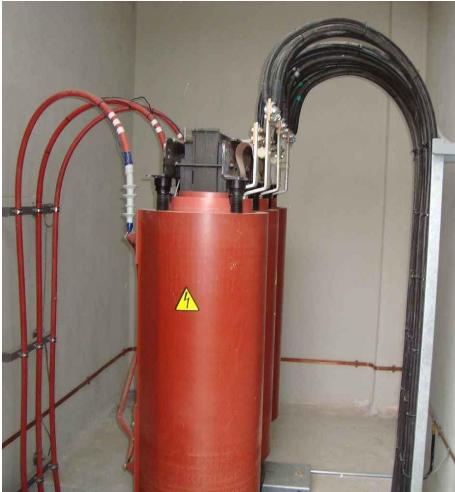
Εικόνα 3.5: Μετασχηματιστής Ξηρού Τύπου
