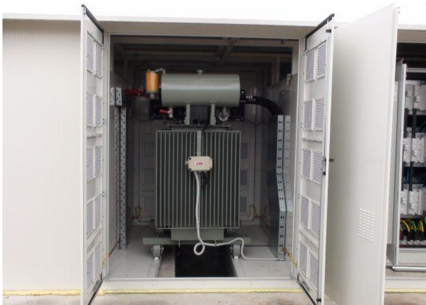
Εικόνα 2.5: Επίγειος Υποσταθμός Μ.Τ
