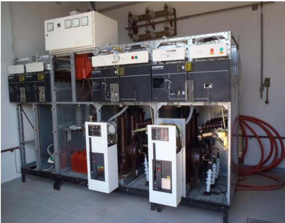
Εικόνα 3.1: Πίνακες Μέσης Τάσης
