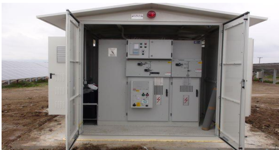
Εικόνα 2.3: Εξωτερικός Υποσταθμός Μ.Τ
