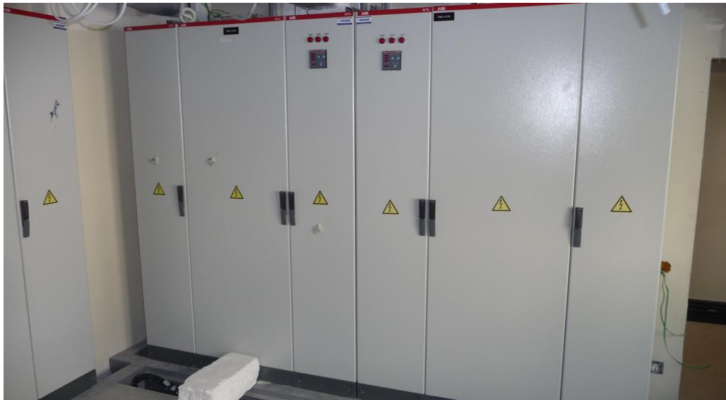
Εικόνα 3.7: Πίνακες Χαμηλής Τάσης (Τύπου Πεδίων)
