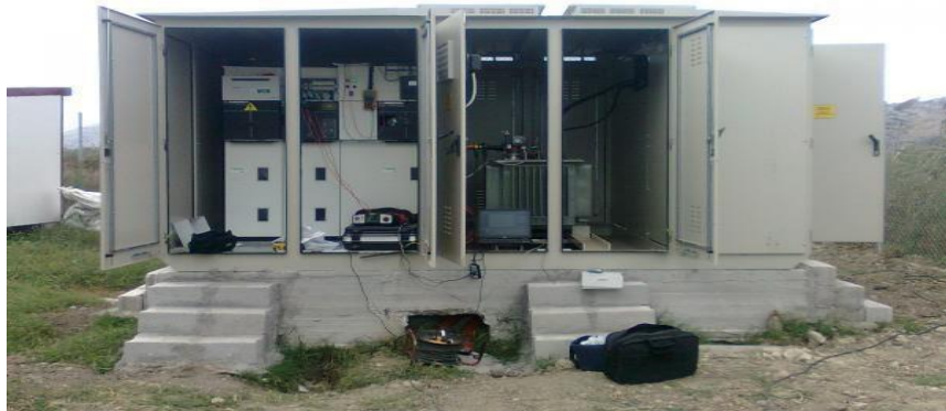
Εικόνα 2.4: Εξωτερικός Υποσταθμός Μ.Τ
