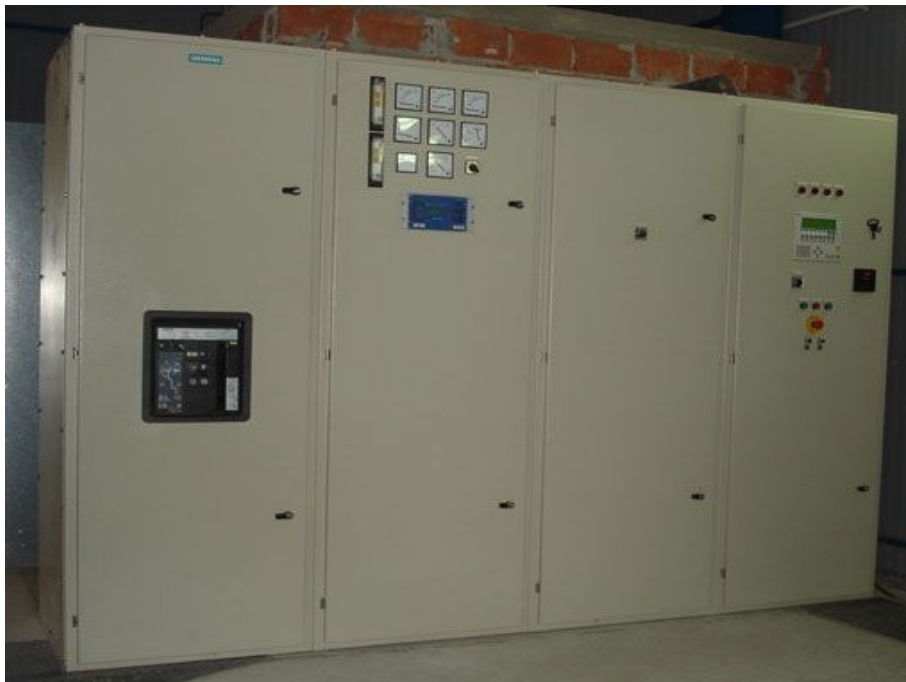
Εικόνα 6.11: Πίνακας ελέγχου και τροφοδοσία [35]
