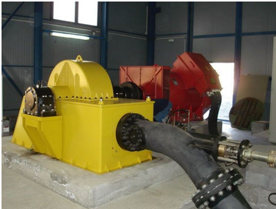
Εικόνα 6.9:Εγκατεστημένος υδροστροβίλος Pelton [35]
