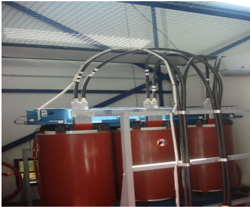
Εικόνα 6.12: Μετασχηματιστής ανύψωσης ΜΥΗΕ
