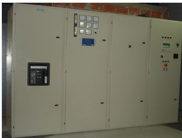
Εικόνα 2.22: Ηλεκτρικός πίνακας ΜΗΥΕ
