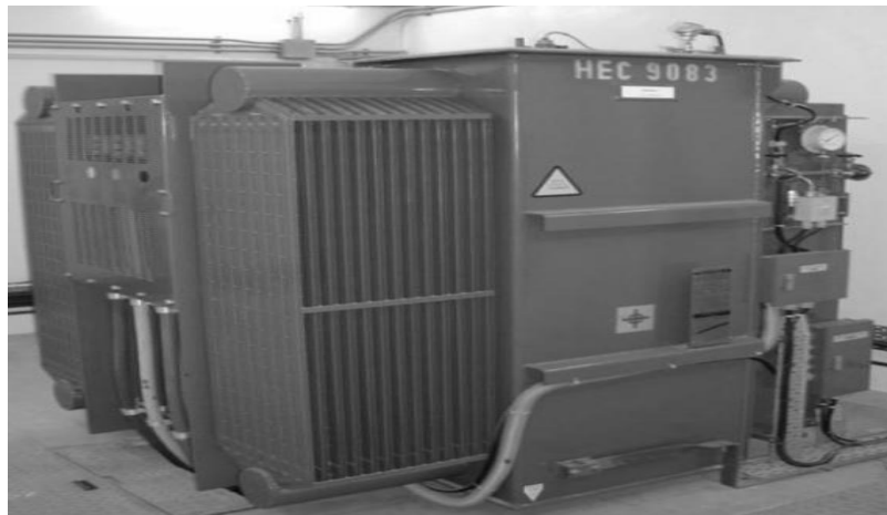
Σχήμα 3.17 – Μετασχηματιστής ισχύος 1500 KVA με μόνωση SF 6 .
