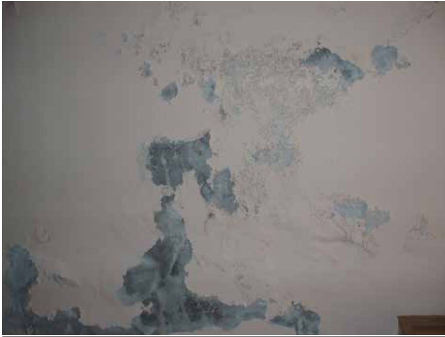
Εικ.52 Τοίχος υπογείου-Φθορές
