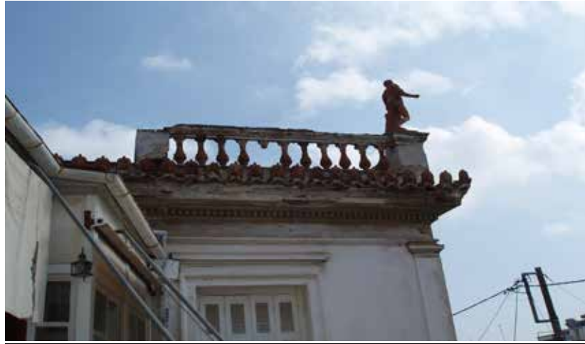
Εικ.14 Καταστροφή των στηθαίων
