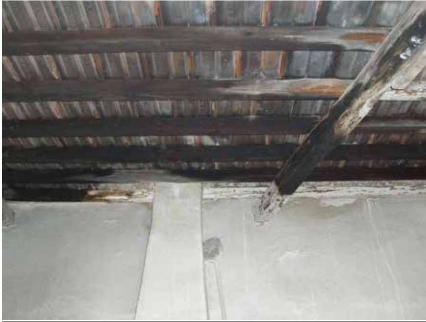
Εικ.20 Κατεστραμμένη στέγη ισόγειου κτίσματος
