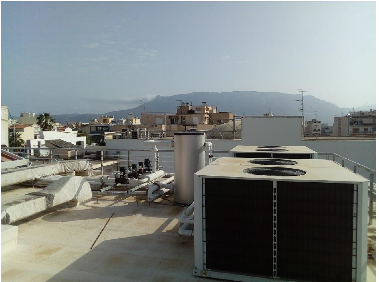
Εικόνα 2.17: Μεγάλες κλιματιστικές μονάδες.”
