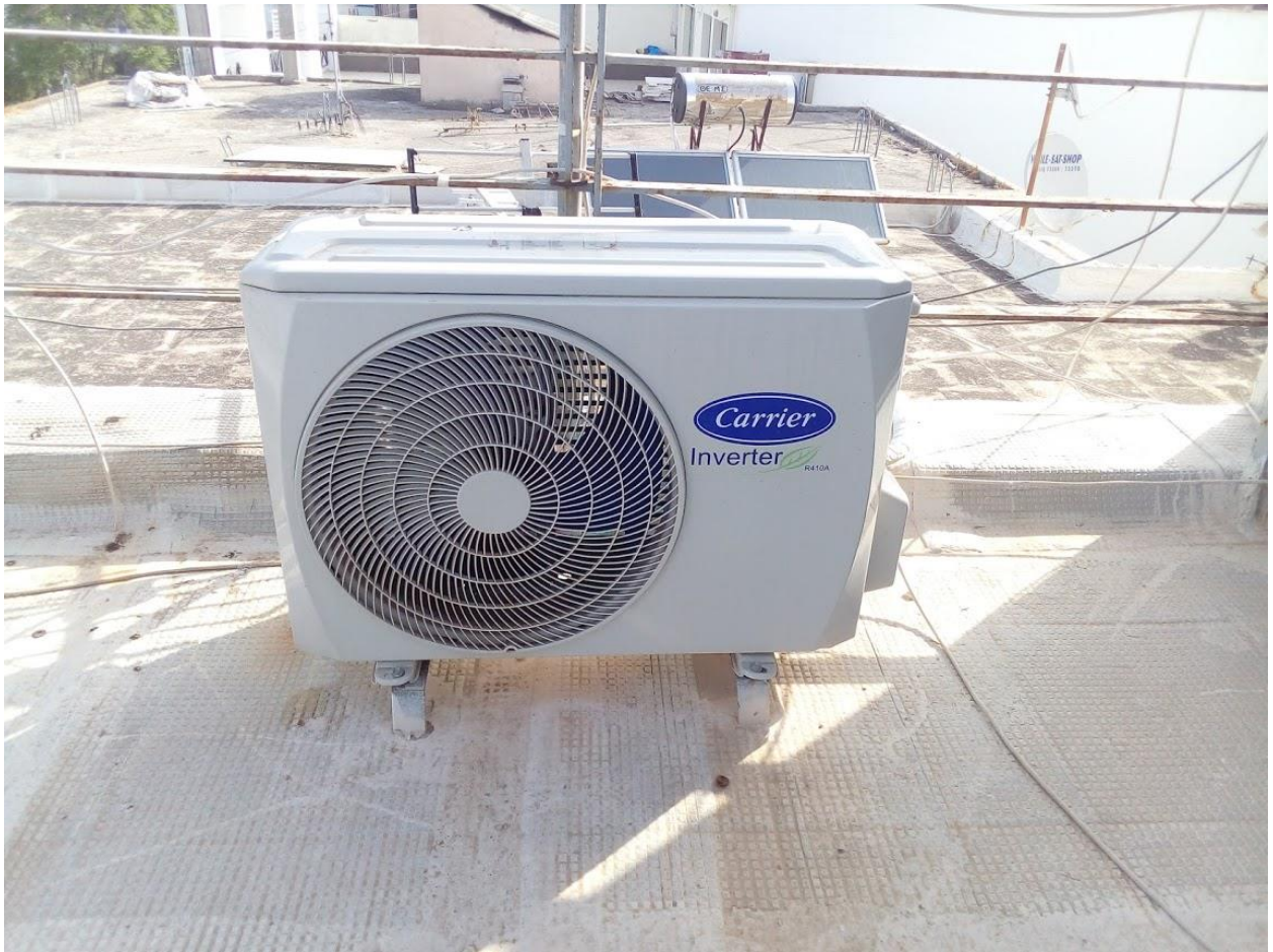
Εικόνα 2.13: “Κλιματιστική μονάδα τύπου split .”
