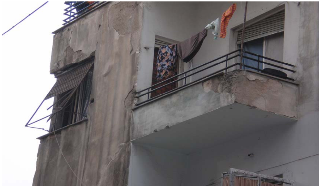
Εικόνα 27. Τριώροφο κτίριο στην οδό ΑΝΑΞΑΓΟΡΑ. Είναι ολοφάνερη η κακή κατάσταση του. Κι όμως ο ιδιοκτήτης του απολαμβάνει τα έσοδα τα οποία προέρχονται από οικονομικούς μετανάστες.
