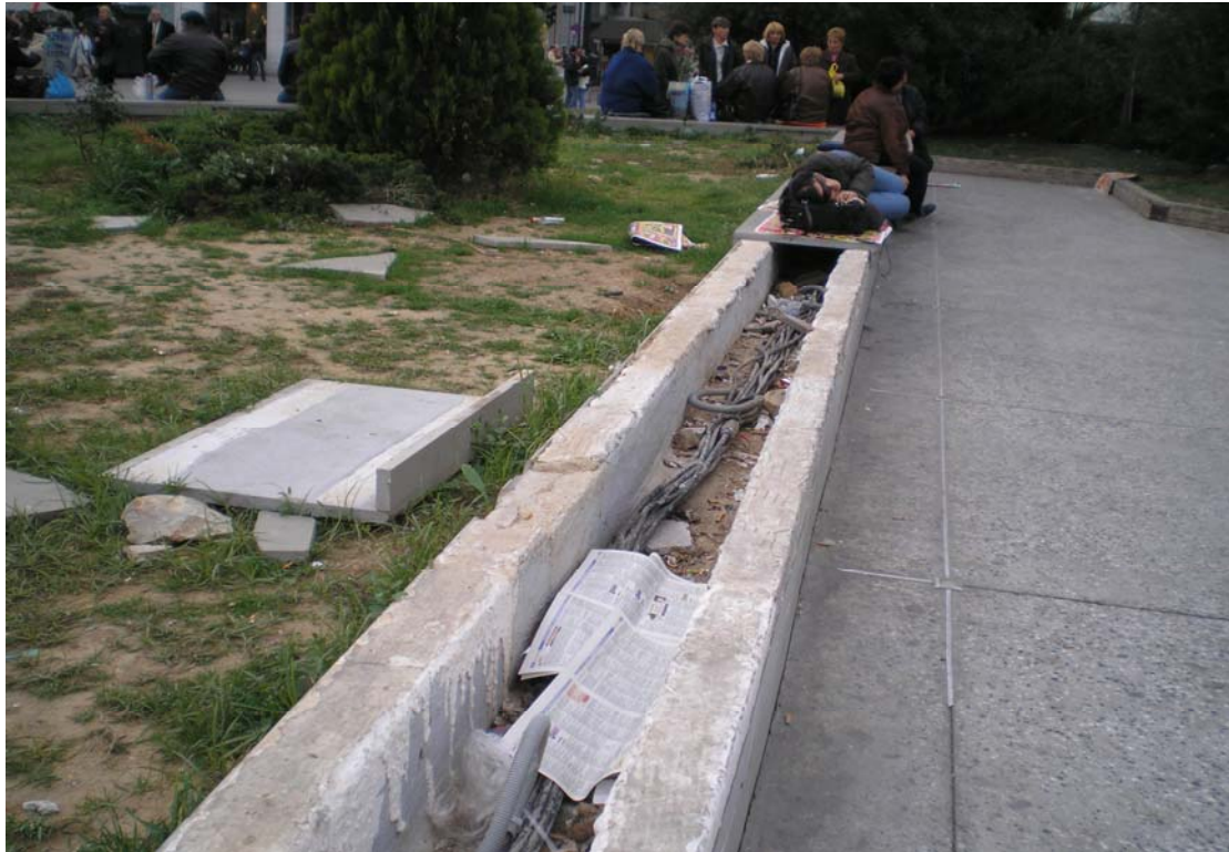
Εικόνα 39. Σημερινή κατάσταση στηθαίου που ήταν επενδυμένη από μάρμαρο γρανίτη. Σήμερα χρησιμεύει σαν αυλάκι σκουπιδιών, σαν κρεβάτι για έναν γρήγορο ύπνο και κυρίως σαν πόρτα θανάτου, αφού τα ηλεκτρικά καλώδια είναι εκτεθειμένα μετά το σπάσιμο των μαρμάρων.
