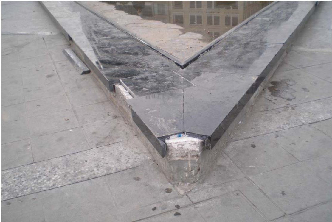
Εικόνα 37. Στηθαίο της υδάτινης δεξαμενής επενδυμένο με γρανίτη. Διακρίνεται η άδεια δεξαμενή και τα σπασμένα μάρμαρα
