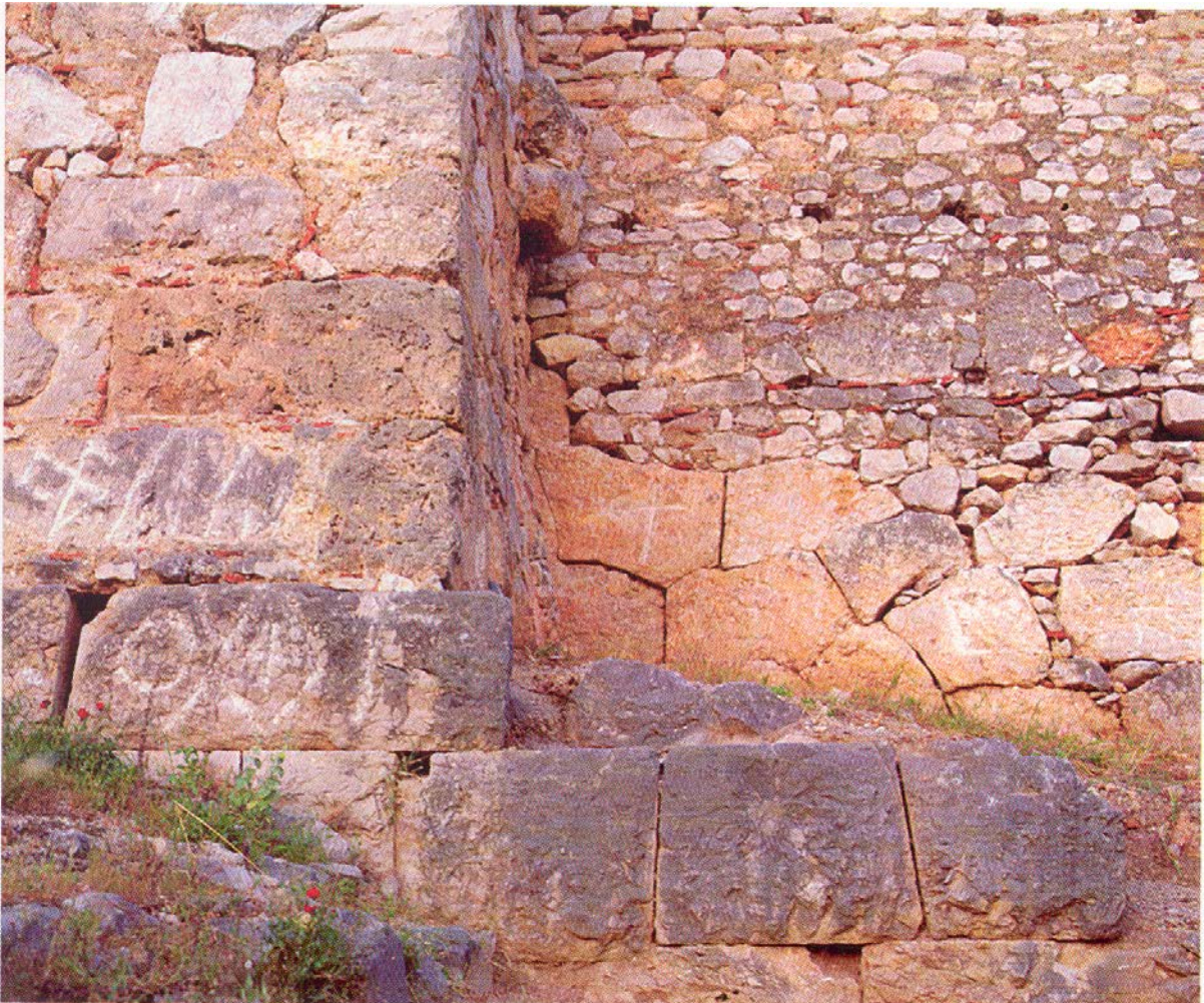
Εικ. 5.1 Τμήμα του τείχους στη βάση της Βορειοδυτικής γωνίας του οχυρωματικού περιβόλου όπου διακρίνονται το τραπεζιόσχημο και το πολυγωνικό δομικό σύστημα.
