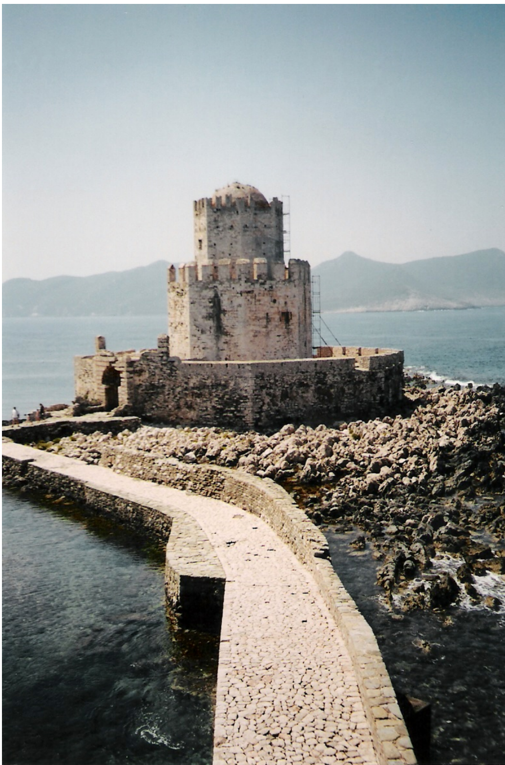
φωτ.37 Το Μπούρτζι στην είσοδο του λιμανιού όπου μπορούμε να διακρίνουμε τις εργασίες αναστήλωσης.
