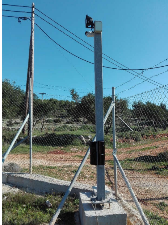
Εικόνα 3.13: Κολώνα με beams κάμερα και προβολέα
