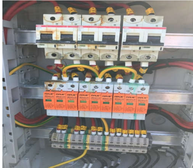
Εικόνα 3.1: Διάβρωση ηλεκτρολογικού υλικού στον πίνακα DC
