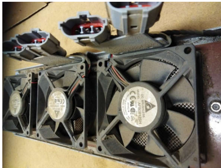
Εικόνα 3.8: Σκόνη στο σύστημα ψύξης του inverter
