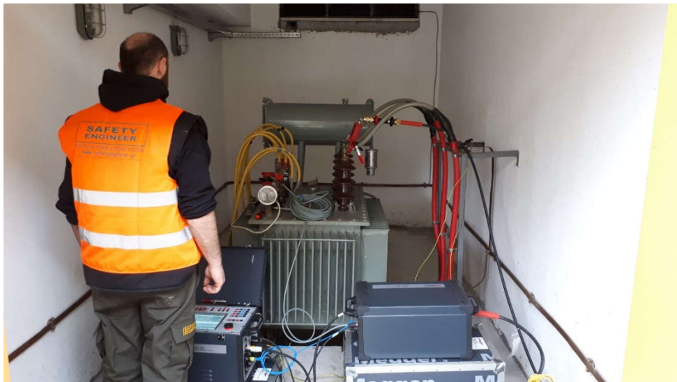
Εικόνα 3.7: Μετρήσεις σε μετασχηματιστή, https://www.safetyengineer.gr
