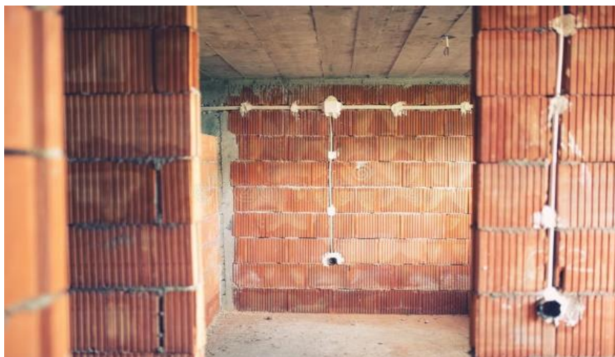
Εικόνα 13: Ηλεκτρική εγκατάσταση (ElectricalNews, 2017)
