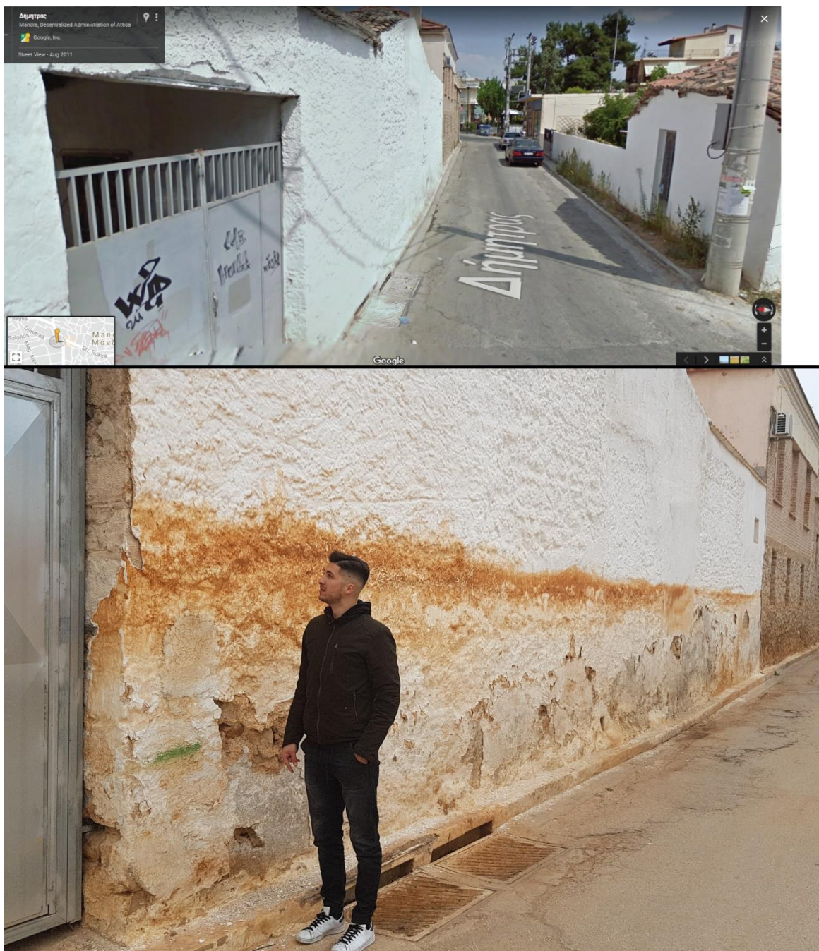
Εικόνα 11. Επί της οδού Δήμητρος (εικόνα 9). το ύψος του νερού όπως φαίνεται από το καφέ κόκκινο χρώμα επί της τοιχοποιίας, προσεγγίζει κάποια στιγμή τα 2 μέτρα (κάτω). Σε σύγκριση με τη κατάσταση πριν το συμβάν (με την βοήθεια του Google street view από το 2012) (πάνω), φαίνονται στην τοιχοποιία οι καταστροφές που προκλήθηκαν από την μεταφορά φερτών υλικών κατά την πλημμύρα
