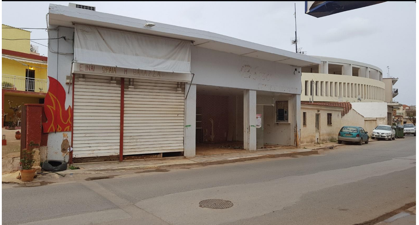
Εικόνα 23. Καταστροφές στο εξωτερικό τμήμα καταστήματος επί της οδού Στ. Ρόκα (εικόνα 9). Ομοίως με την εικόνα 22, η εξωτερική τζαμαρία (πάνω εικόνα, Google street view, 2012), του καταστήματος καταστράφηκε εντελώς (κάτω).
