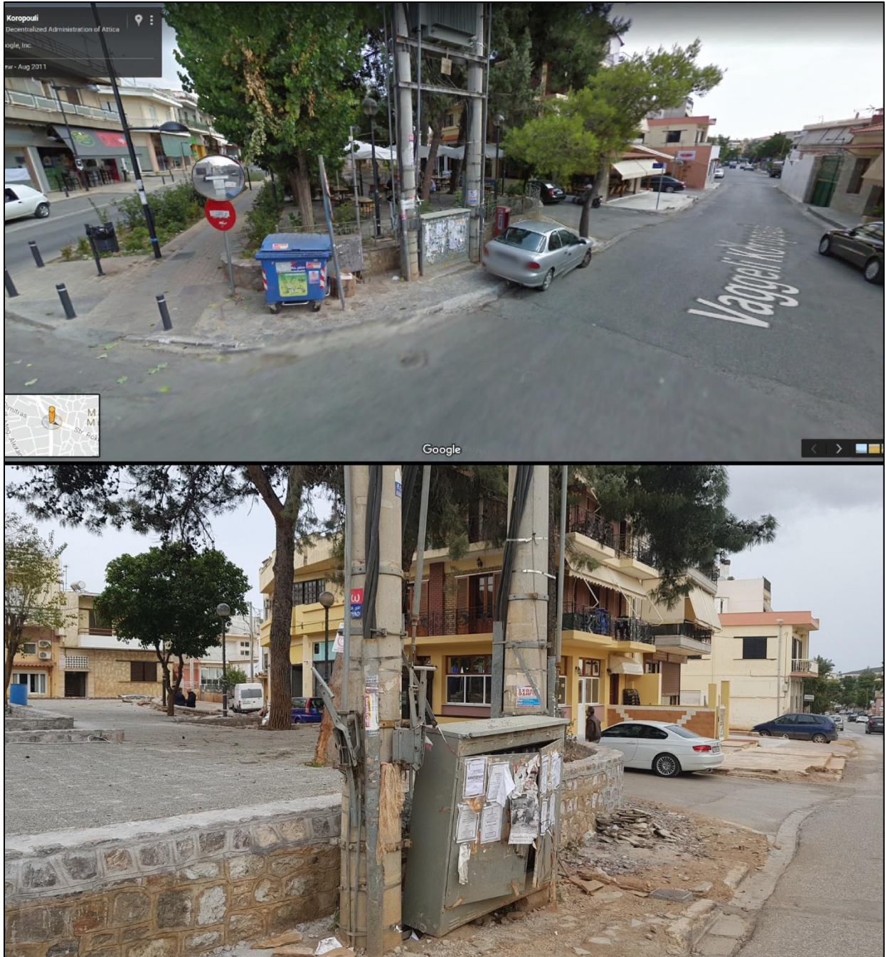
Εικόνα 31. Ενδιαφέρον παρουσιάζουν οι ζημιές στη διασταύρωση Ευάγγελου Κοροπούλη και Στρ. Ρόκα (εικόνα 9), (κάτω εικόνα). Από τις βροχές υπέστη φθορές οι στύλοι της ΔΕΗ και ο υποσταθμός που βρίσκονται περιμετρικά της πλατείας. Το μέγιστο ύψος του νερού (καφέ κόκκινο ίχνος) ήταν περίπου 0,7 μέτρα. Σε σύγκριση με την προτεραία κατάσταση (Google street view, 2012 πάνω εικόνα).
