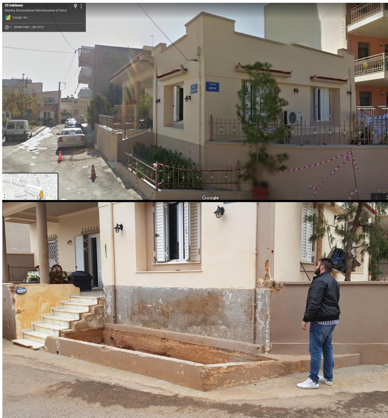
Εικόνα 10. Στην διασταύρωση Δήμητρας και Ηρακλέους το ύψος του νερού έφτασε περίπου το 1,5 μέτρο (κόκκινο καφέ χρώμα τον τοίχο του κτιρίου, κάτω εικόνα) (εικόνα 9). Σε σύγκριση με την πρότερη κατάσταση (πάνω), με την βοήθεια του Google street view από το 2012. Φαίνονται στην τοιχοποιία οι καταστροφές που προκληθήκαν από την μεταφορά φερτών υλικών κατά την πλημμύρα.
