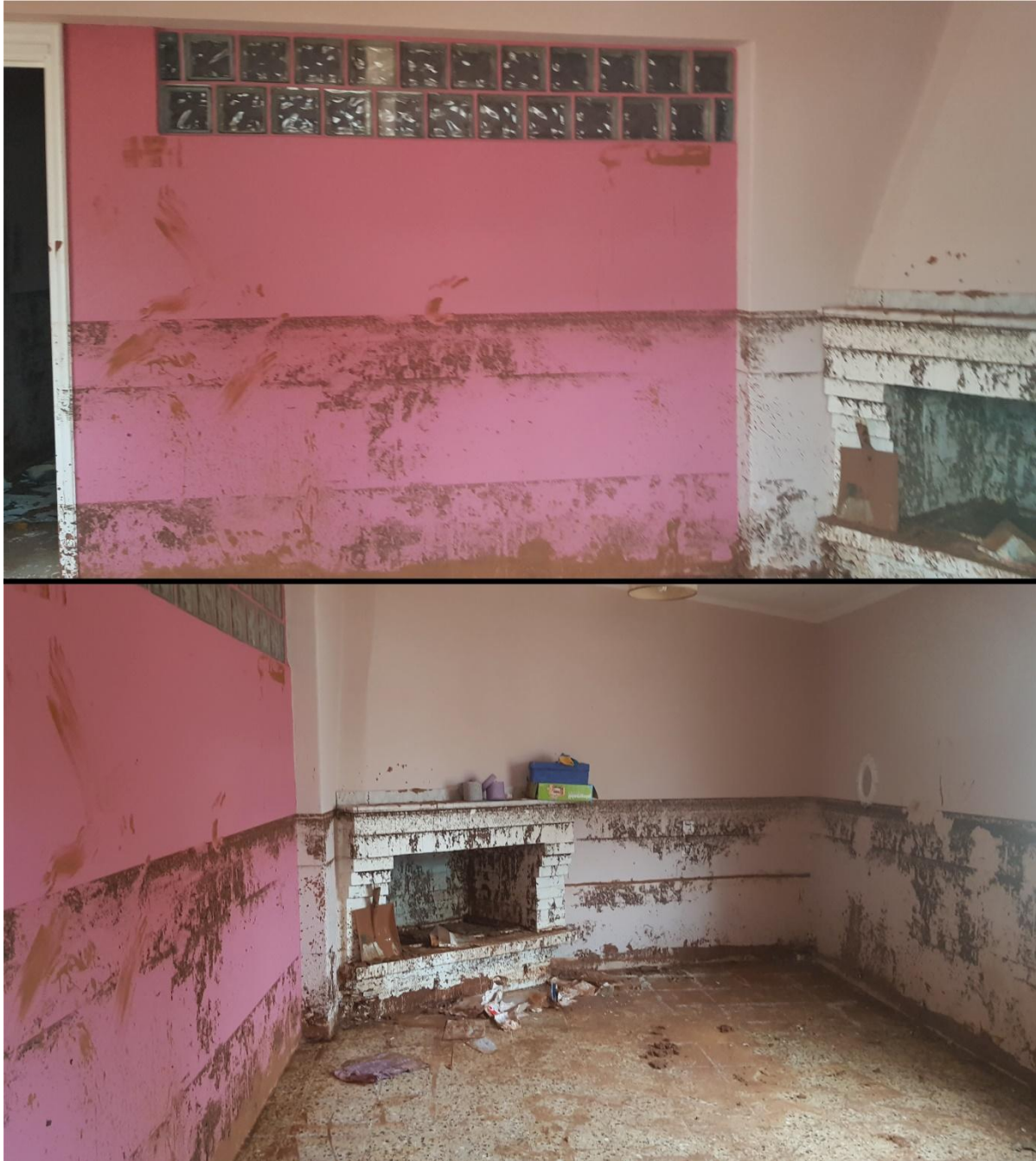
Εικόνα 19. Οι εκτεταμένες καταστροφές που προκληθήκαν εντός οικίας (οδός Δήμητρας 1) (εικόνα 9). Ολόκληρη η οικία είχε καλυφθεί από λάσπες και αδρομερή υλικά που μεταφερθήκαν από την δράση του νερού και παγιδευτήκαν μέσα στο σπίτι. Το μέγιστο ύψος του νερού ήταν περίπου 1 μέτρο (το ψηλότερο καφέ κόκκινο ίχνος), ενώ περίπου 30 εκατοστά ήταν το ίζημα που έμεινε μετά την απόσυρση των νερών, σύμφωνα με τις μαρτυρίες κάτοικων.
