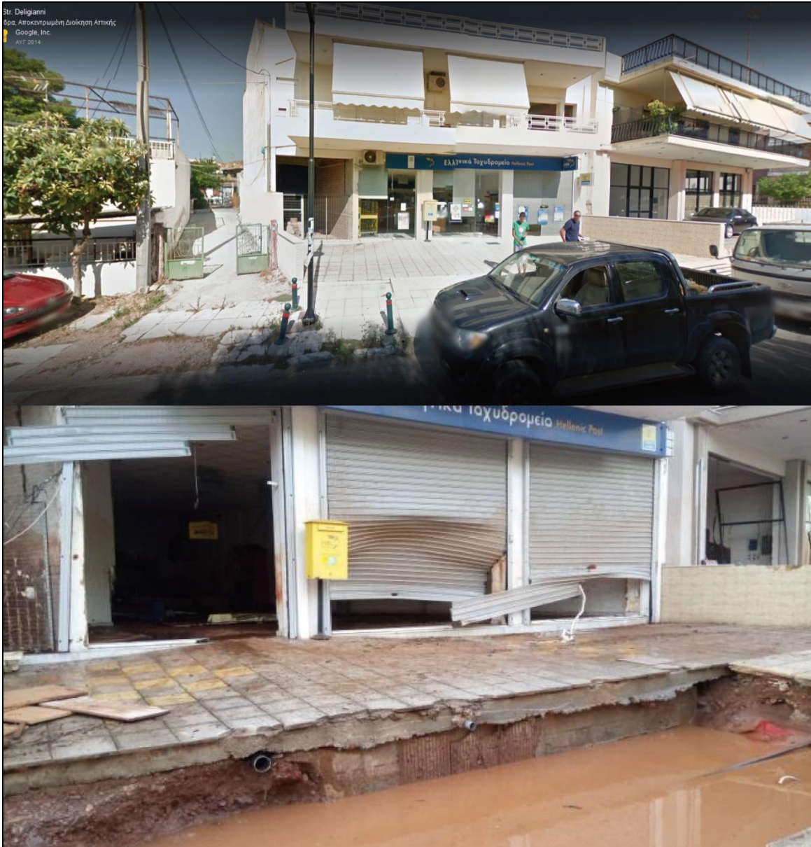
Εικόνα 34. Πλήρης καταστροφή του οδικού δικτύου με υποσκαφή του πεζοδρομίου περίπου κατά 50 εκατοστά επί της οδού Κοροπούλη 28(εικόνα 9) (σε σύγκριση με την προτεραία κατάσταση από το Google street view, 2014 πάνω εικόνα), ακριβώς μπροστά από το υποκατάστημα των Ελληνικών Ταχυδρομείων. Το υποκατάστημα έχει υποστεί σοβαρές ζημιές από την δράση του νερού με την τζαμαρία και τα προστατευτικά ρολά να είναι πλήρως κατεστραμμένα. Άξιο αναφοράς είναι η φθορές που φαίνονται στο δίκτυο υδροδότησης (κάτω εικόνα, τροποποιημένο από Λέκκας κα., 2017).
