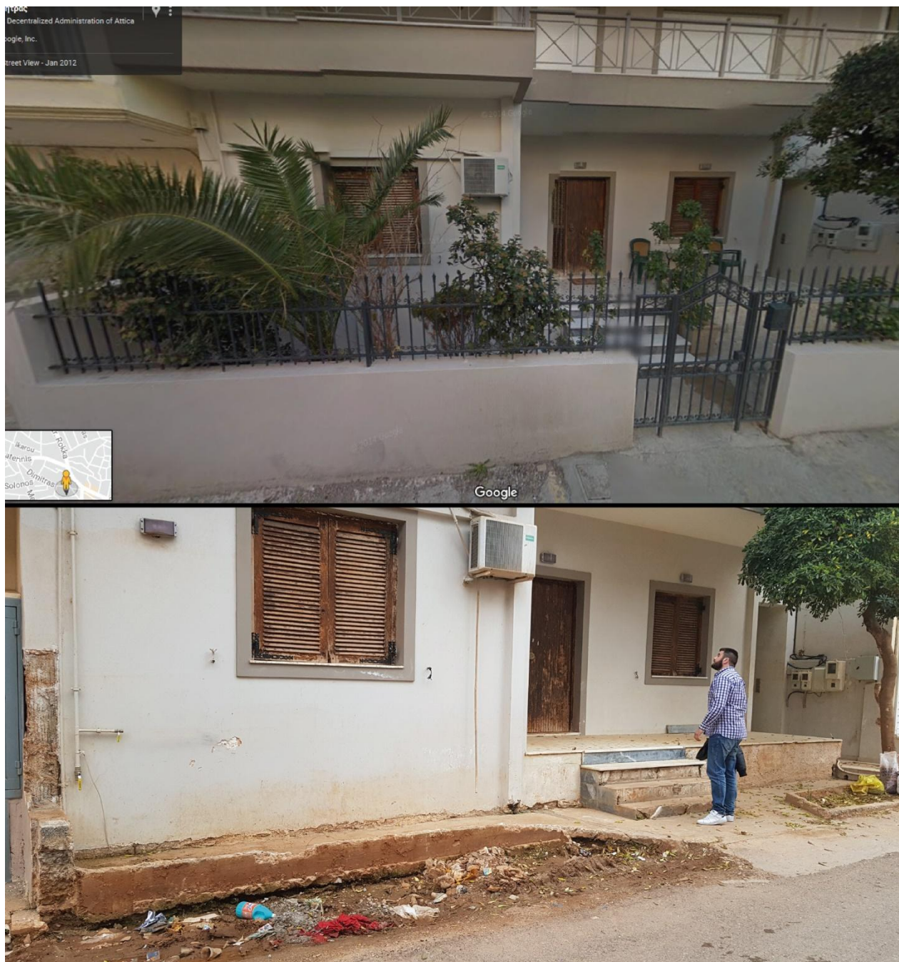
Εικόνα 21. Σοβαρές καταστροφές στο εξωτερικό οικίας στην οδό Δήμητρας (εικόνα 9). Εξωτερικά τοιχία που υπήρχαν (πάνω), όπως φαίνονται στο Google street view (2012) και έχοντας σαν βάση την περιγραφή των κατοίκων την περιοχή, έχουν καταστραφεί ολοσχερώς (κάτω). Έχει σκαφτεί ο χώρος που ήταν η εξωτερική αυλή από την δράση του νερού, ενώ από την μεταφορά μπαζών παρατηρούνται ζημιές στην εξωτερική όψη του κτηρίου.
