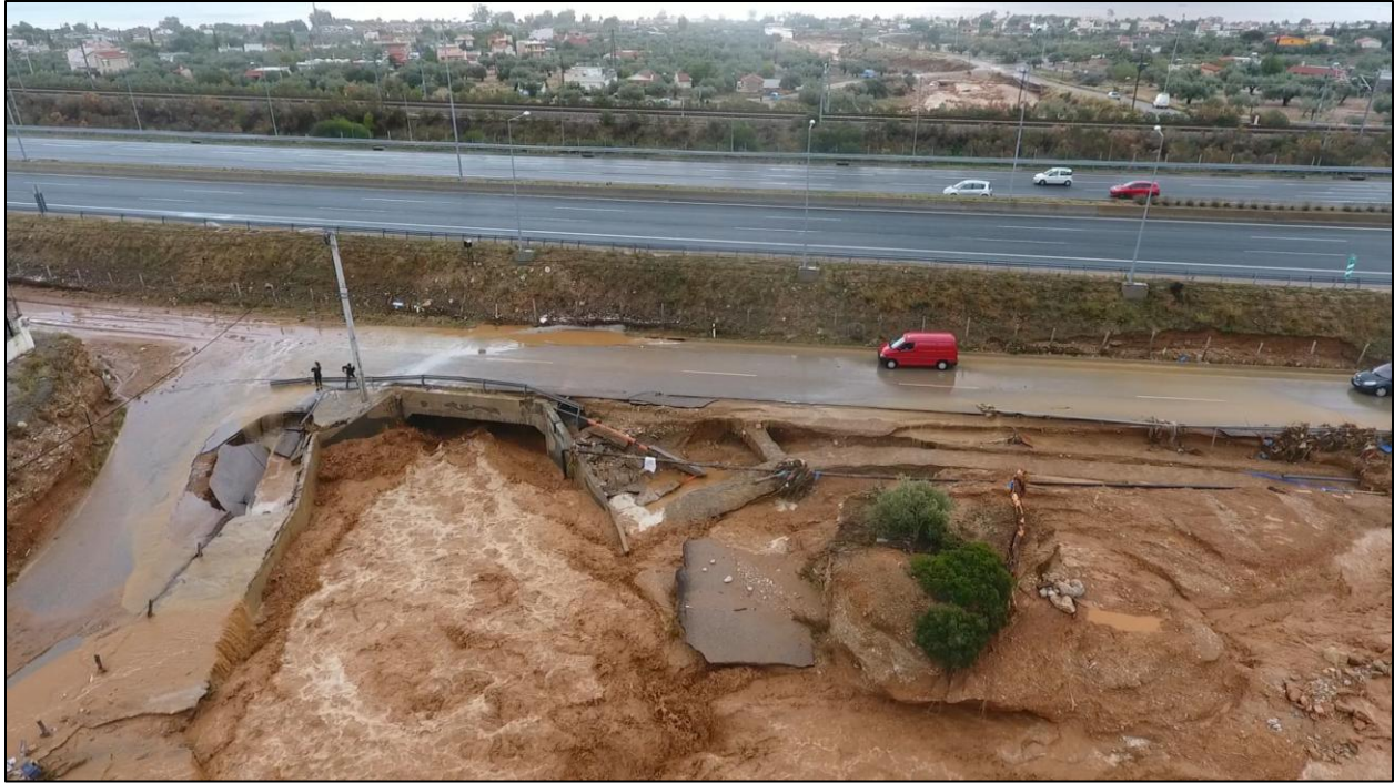
Εικόνα 39. Εκτεταμένες καταστροφές του οδικού δικτύου στην γέφυρα στο ύψος της εθνικής οδού στο κόμβο της Νέας Περάμου. (τροποποιημένο από Λέκκας κα., 2017),
