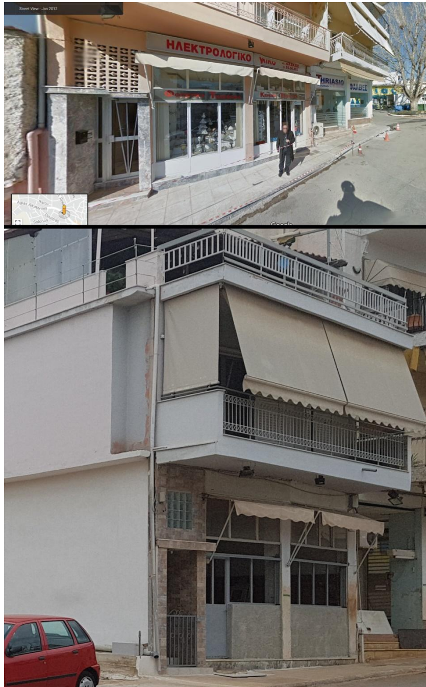
Εικόνα 28. Καταστροφές στο εξωτερικό τμήμα καταστήματος επί της οδού Αγ. Αικατερίνης (εικόνα 9). Ομοίως με τις εικόνες 22, 23, η εξωτερική τζαμαρία (πάνω εικόνα, Google street view, 2012), του καταστήματος καταστράφηκε εντελώς (κάτω).
