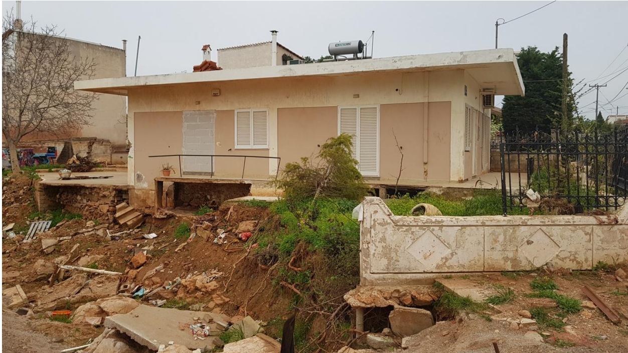
Εικόνα 33. Σοβαρές καταστροφές στο οδικό δίκτυο από την πλημμύρα, ενώ έχουν υποσκαφτεί και τα θεμέλια του σπιτιού ως έναν βαθμό επί τη οδού Κοροπούλη (εικόνα 9). Το αποστραγγιστικό αυλάκι που υπήρχε έχει εξαφανιστεί εντελώς, καθώς και το δίκτυο ύδρευσης.
