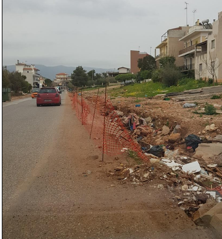
Εικόνα 35. Σοβαρές καταστροφές στο οδικό δίκτυο από την πλημμύρα, επί τη οδού Κοροπούλη (εικόνα 9). Το αποστραγγιστικό αυλάκι που υπήρχε έχει εξαφανιστεί εντελώς.
