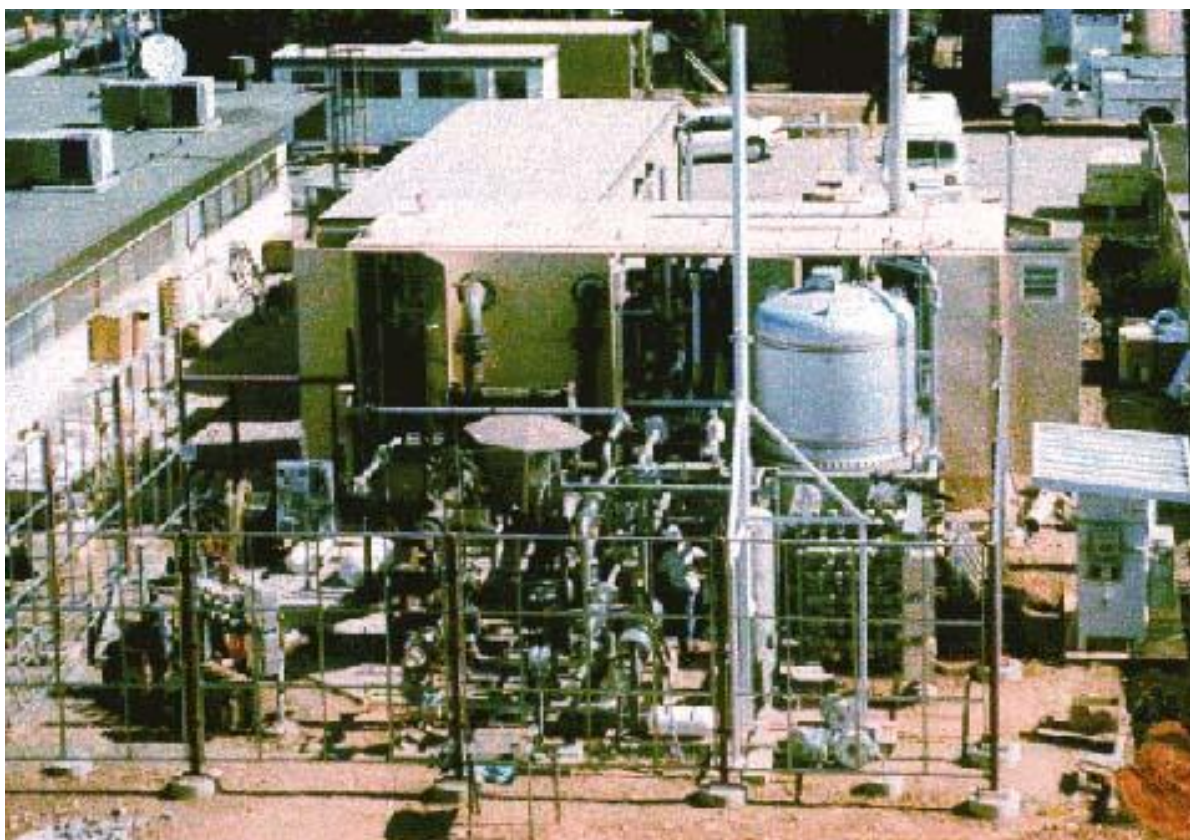
Εικόνα 2.5.2: Χρήση MCFC σε σταθμό ηλεκτροπαραγωγής στο San Diego, California, 1997
