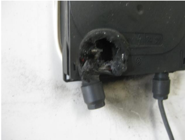
Εικόνα 2-10 Βλάβη στο κουτί σύνδεσης Πηγή: rimstar.org
