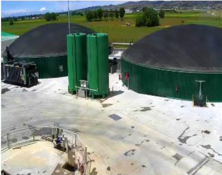
Εικόνα 18 Εγκαταστάσεις Βιοαέριο Λαγκαδά
