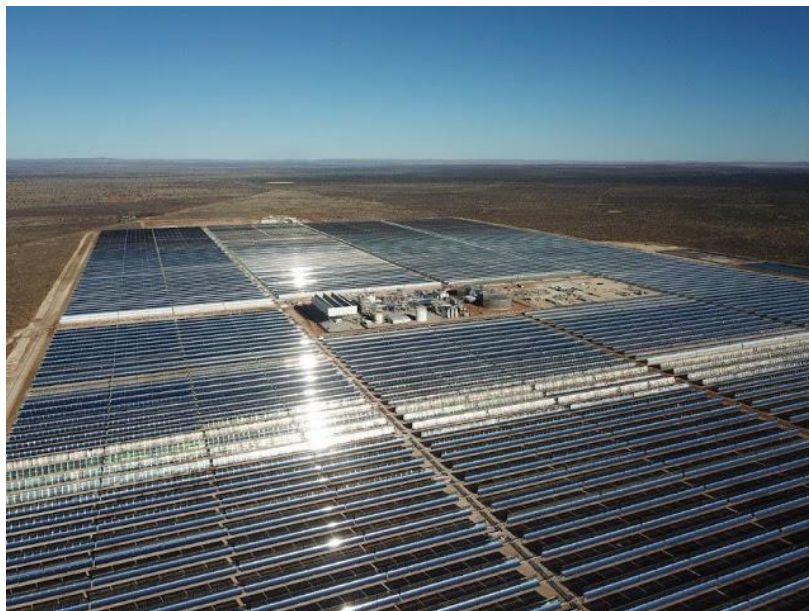
Σχήμα 5.1 Μονάδα Παραγωγής στο κέντρο της εγκατάστασης (Kathu Solar Power Plant, South Africa)
