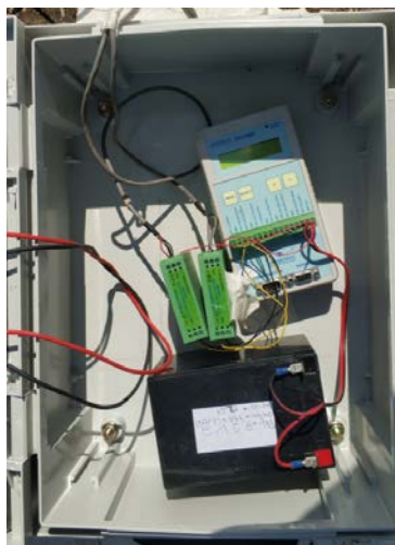
Σχήμα 4.5 - Καταγραφικό πυρανομέτρων μέτρησης λευκαύγειας με ενισχυτές τάσης και μπαταρία 12V
