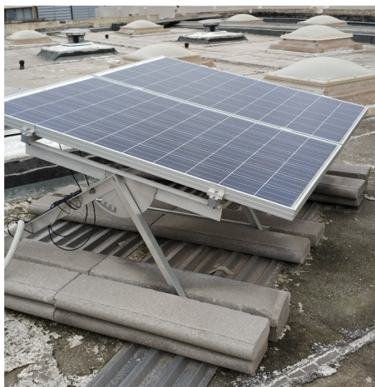
Σχήμα 3.1 - Φωτοβολταϊκά πλαίσια aleo
