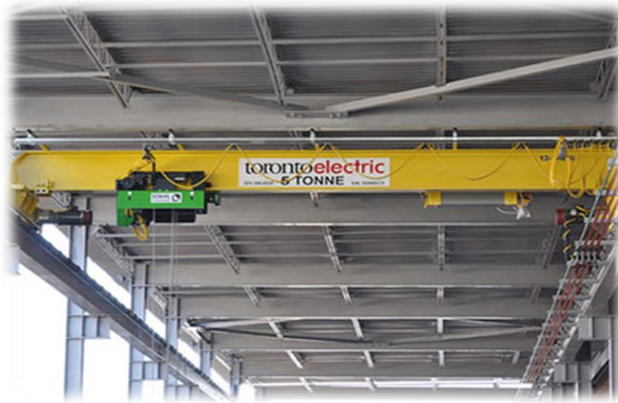
Εικόνα 4: Γερανογέφυρα εγκατεστημένη σε μονάδα παραγωγής (Torontoelectric.com, 2019)
