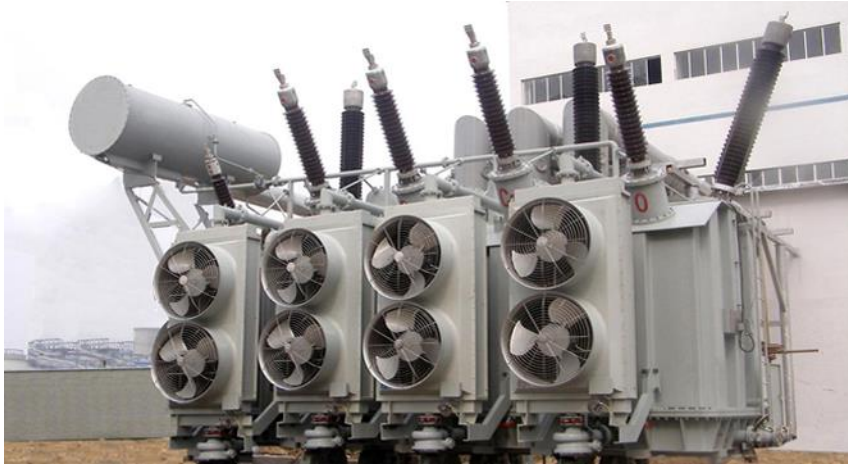
Εικόνα 3.2 Ανεμιστήρες ψύξης σε έναν τριφασικό μετασχηματιστή. [45]
