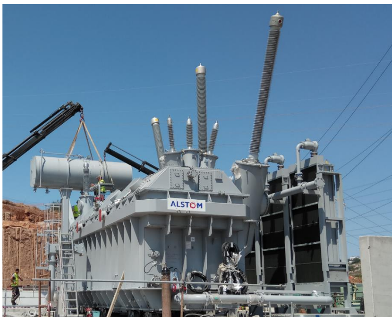
Εικόνα 3.5: Τριφασικός μετασχηματιστής 280 MVA/400 – 150 - 30 kV τύπου OFAF σε ηλεκτρικό υποσταθμό του Λαυρίου κατά την κατασκευή. [Προσωπικό αρχείο]
