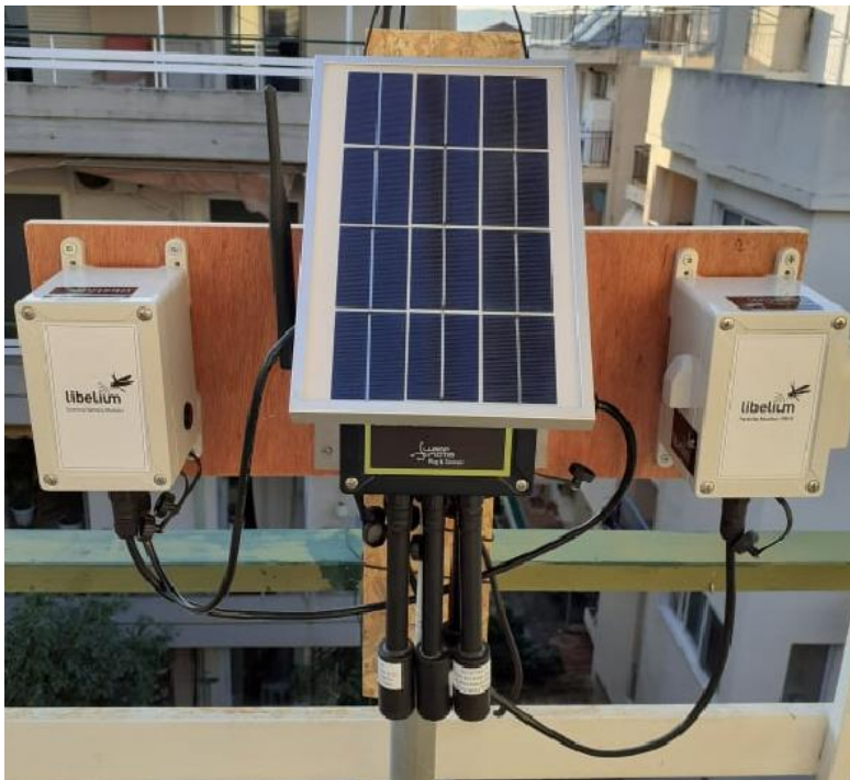
Εικόνα 4.11: Διάταξη βασικού εξοπλισμού σε σύνδεση με φωτοβολταϊκό πάνελ και μπαταρία (Πηγή: Προσωπικό αρχείο)
