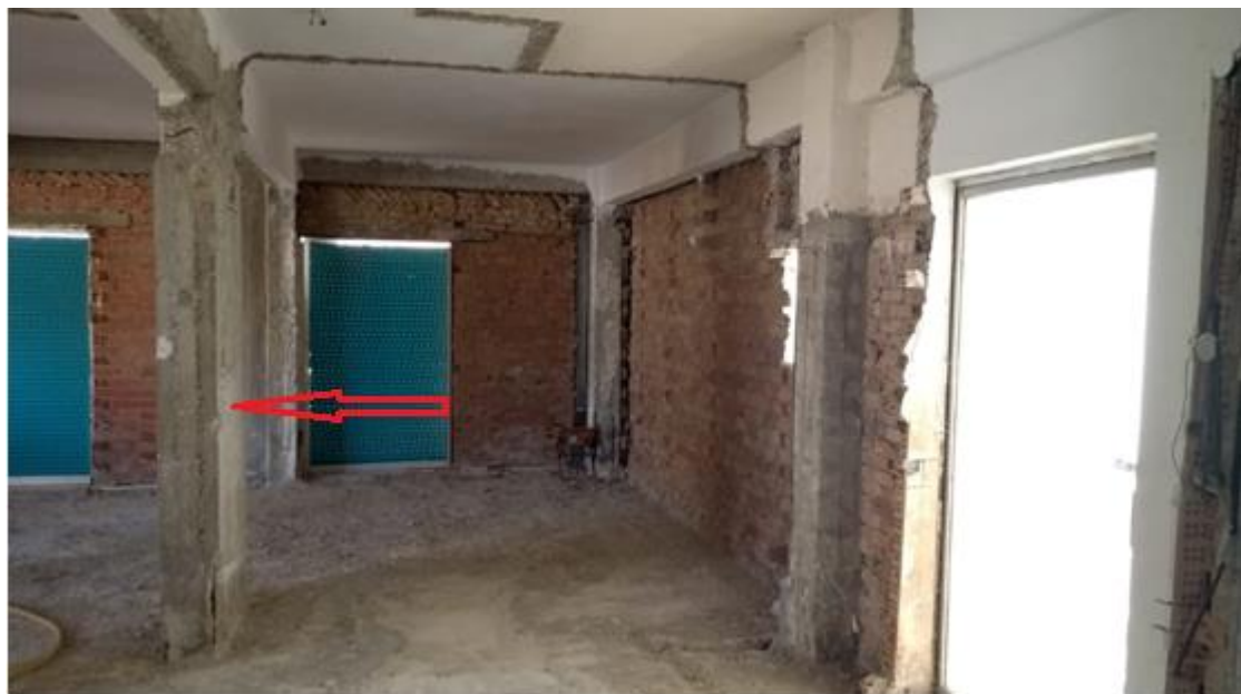
Σχήμα 6. 5: Ένα από τα υποστυλώματα που χρήζει επισκευής – 800*200mm (Πηγή: Αρχείο συγγραφέα)
