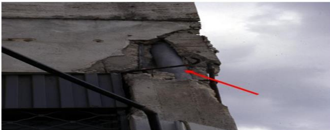
Σχήμα 2. 8: Αστοχία κόμβου και απώλεια περισιφίξης συνδετήρων λόγω τοποθέτησης υδρορροής εντός του υποστρώματος
