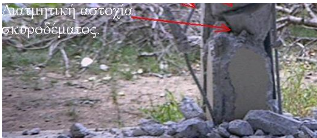
Σχήμα 2. 4: Διατμητική αστοχία υποστυλώματος (Πηγή: http://ecourses.dbnet.ntua.gr/9420.html )
