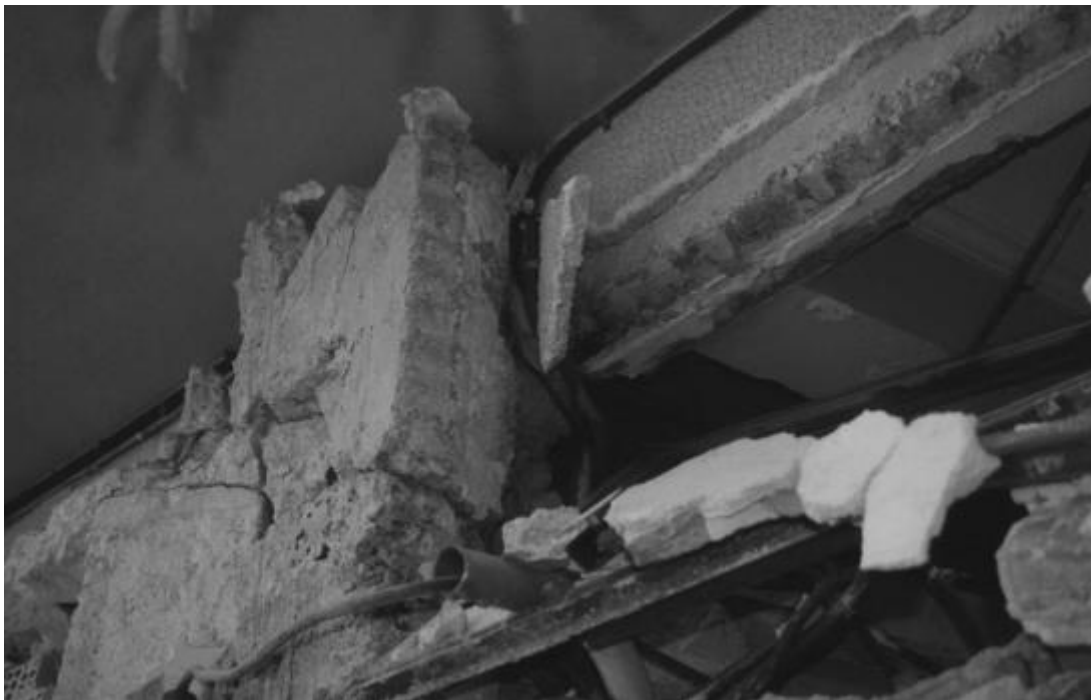
Σχήμα 2. 6: Βλάβη κόμβου μεταξύ υποστυλώματος και συντρέχουσες δοκούς 4
