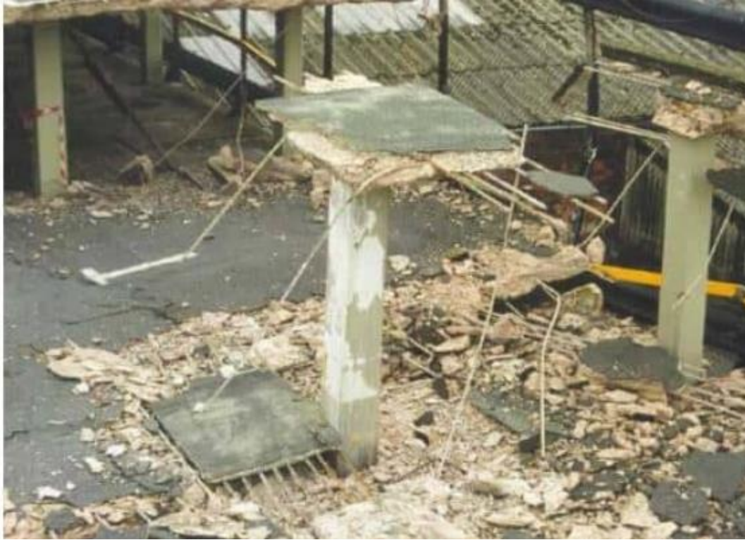
Σχήμα 2. 12: Αστοχία λόγω διάτρησης στο Piper's Row Car Park, Wolverhampton, UK 13
