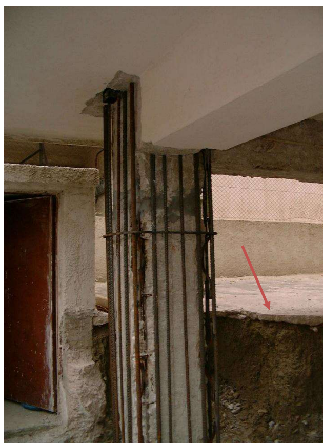
ΕΙΚΟΝΑ 4.42: Εδώ διακρίνεται πλήρως το φάτνωμα δεξιά της Κ9. Το τοιχείο έφτανε μέχρι τη μέση, εκεί όπου φαίνεται το υπό καθαίρεση έδαφος & δάπεδο. Το σωστό θα ήταν να υπήρχε αρμός μεταξύ αυτού και του υποστύλωματος, αλλιώς αν ήταν σε επαφή, θα έπρεπε να φτάνει μέχρι την κάτω παρειά της δοκού οροφής ισογείου, της οποίας την κρέμαση βλέπουμε πάνω-δεξιά.
