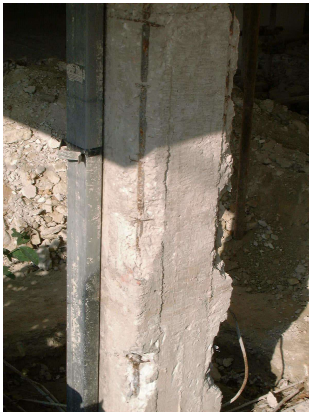
ΕΙΚΟΝΑ 4.47: Οριζόντια καμπτική ρωγμή στη στέψη της K27.
