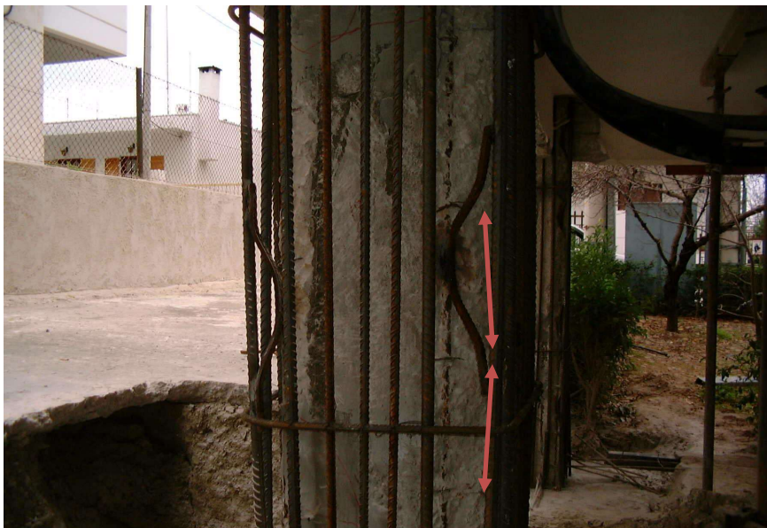
ΕΙΚΟΝΑ 4.45: Η K18 και η K27 στο βάθος. Στην πάγια σύνδεσης του νέου με τον υφιστάμενο οπλισμό, διακρίνουμε εκατέρωθεν τα τσέρκια του παλιού υποστυλώματος και τα οποία είναι αραιά τοποθετημένα (για τα σημερινά δεδομένα), ανά περίπου 0,20m. Ωστόσο ανταποκρίνεται στη μελέτη, οπότε εδώ δεν υπάρχει παρατηρία.
