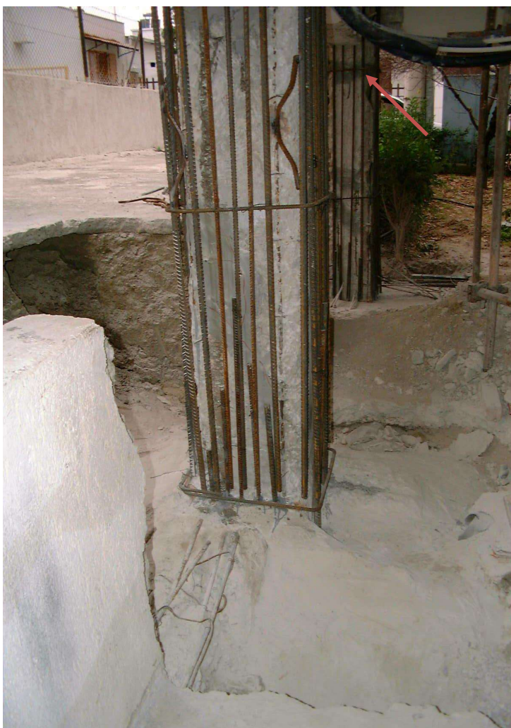
ΕΙΚΟΝΑ 4.46: Η K18 και η K27 στο βάθος. Η άνω παρειά του ενισχυόμενου θεμελίου είναι μερικά εκατοστά χαμηλότερα από το δάπεδο της pilotis, άρα το βάθος θεμελίωσης δεν είναι μεγάλο. Αριστερά βλέπουμε το τοίχείο, που έχει καθαιρεθεί για όσο μήκος χρειάζεται ώστε να γίνουν οι επεμβάσεις. Παρόμοιες καμπτοδιατμητικές ρωγμές στο μέσο και καμπτική ρωγή στη στέψη της K27.
