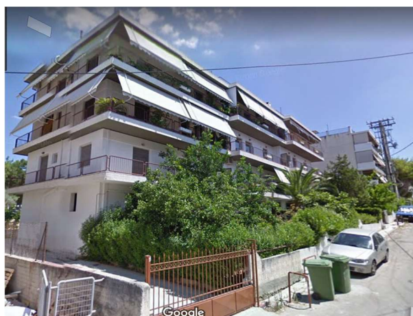
ΕΙΚΟΝΑ 29: Πρόσοψη με εμφανή την κλίση του δρόμου. Το ισόγειο έκλεισε μετά από επεμβάσεις ενίσχυσης.
