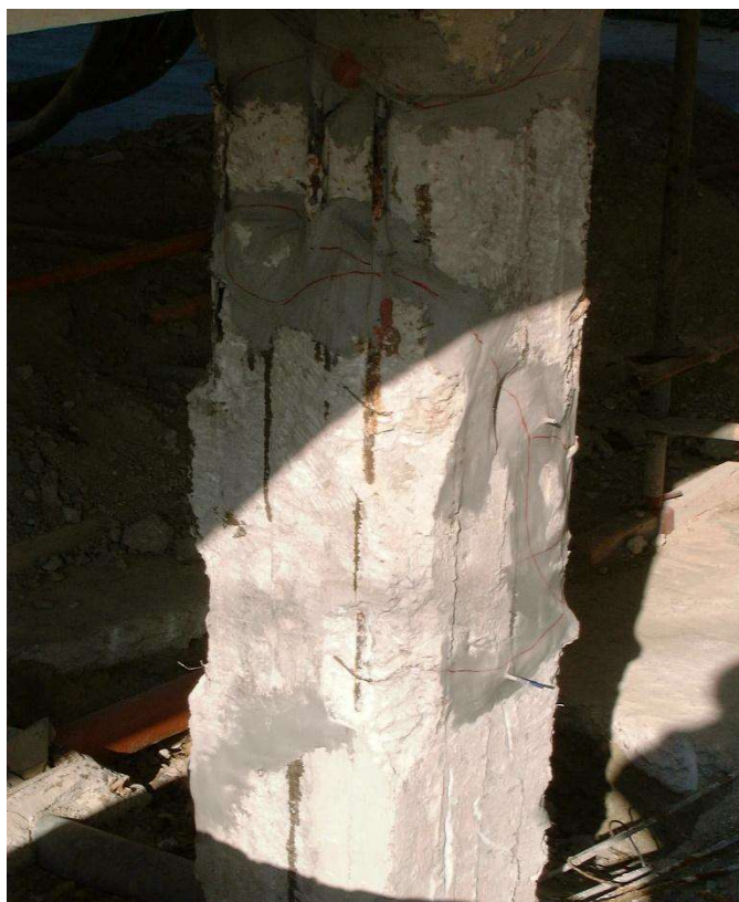
ΕΙΚΟΝΑ 4.44: Εφαρμογή ενέματος στις καμπτοδιατμητικές ρωγμές της Κ18. Οι πορεία των ρωγμών (βλ. κόκκινες γραμμές), μαρτυρούν ανακυκλιζόμενη φόρτιση.
