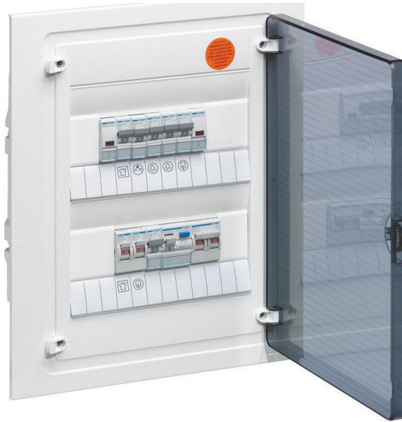
Εικόνα 6 Ηλεκτρολογικός πίνακας σπιτιού
