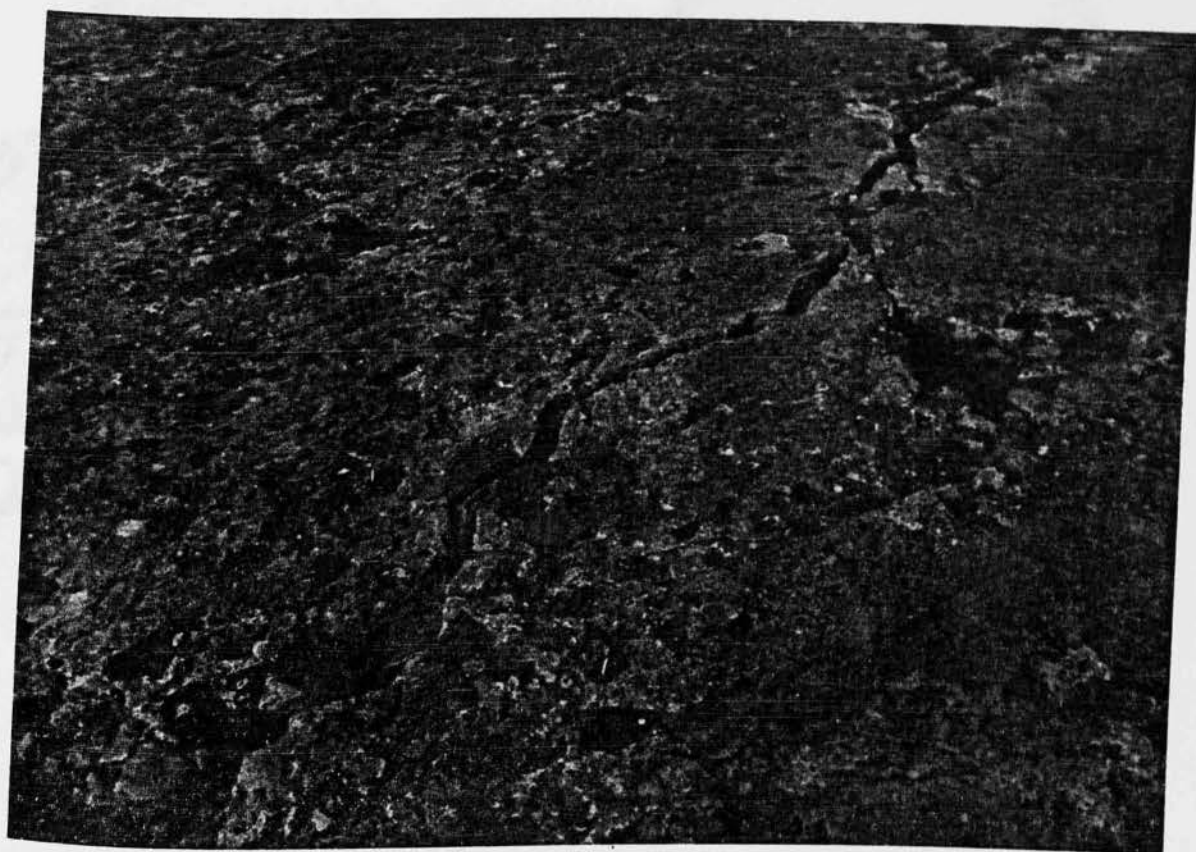
Εικόνα 3.24.: Η ρωγμή στην οροφή – Σε κάποια σημεία το άνοιγμα (πλάτος) της ρωγμής φτάνει και στα 7-8εκ.
