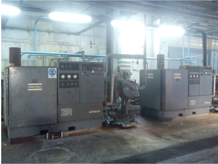
Εικόνα 5.1: Οι δυο αεροσυμπιεστές Atlas Copco του εργοστασίου
