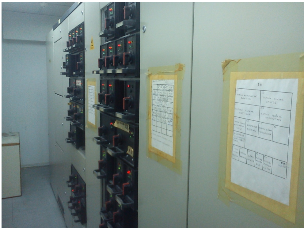
Εικόνα 5.4: MCC στον χώρο της Ραφινερί (πίσω)
