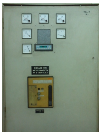
Εικόνα 5.9: Πίνακας μετασχηματιστή Νο3 (ισόγειο) 1600kVA
