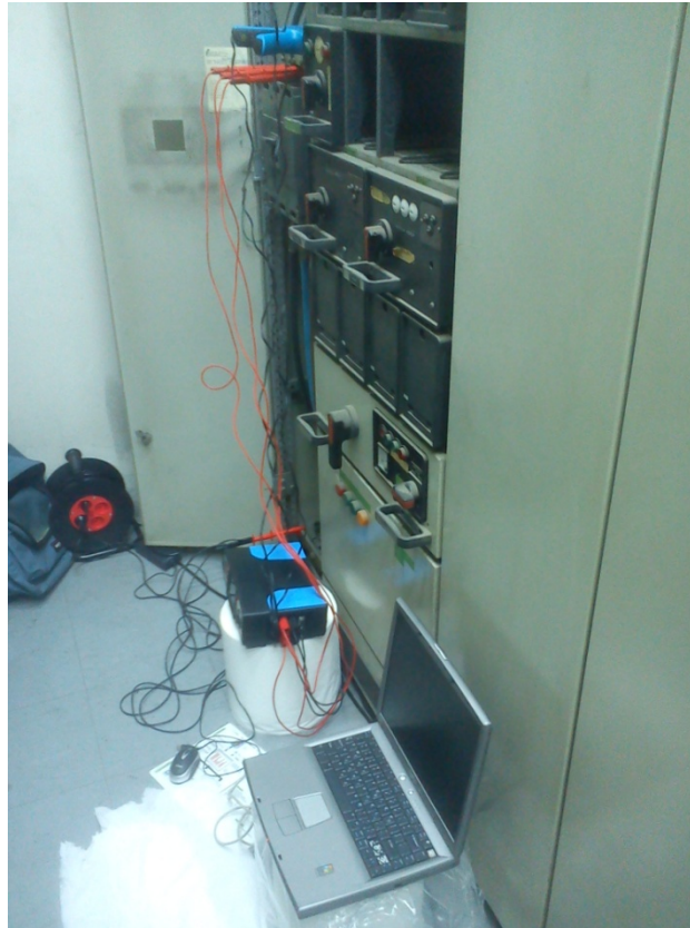
Εικόνα 5.5: Μετρήσεις στον πίνακα της Ραφινερί
