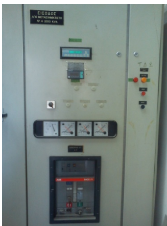
Εικόνα 5.10: Πίνακας μετασχηματιστή Νο4 (1 ος Όροφος) 1000kVA
