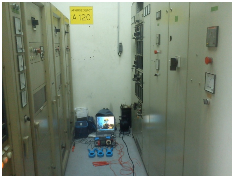
Εικόνα 5.7: Υποσταθμός 1 ου ορόφου
