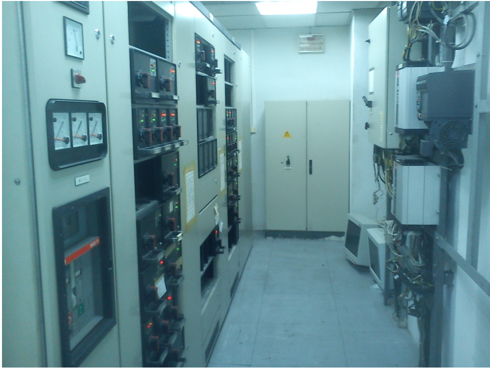
Εικόνα 5.3: MCC στον χώρο της Ραφινερί (εμπρός)
