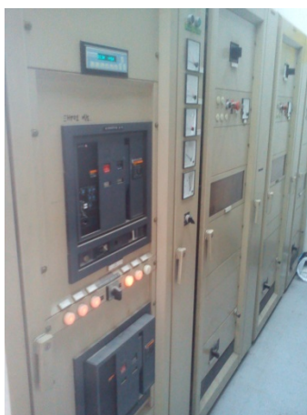
Εικόνα 5.11: Πίνακας μετασχηματιστή Νο2 (1 ος Όροφος) 1000kVA
