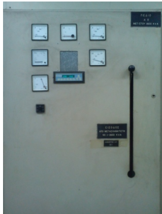
Εικόνα 5.8: Πίνακας μετασχηματιστή Νο1 (ισόγειο) 1600kVA
