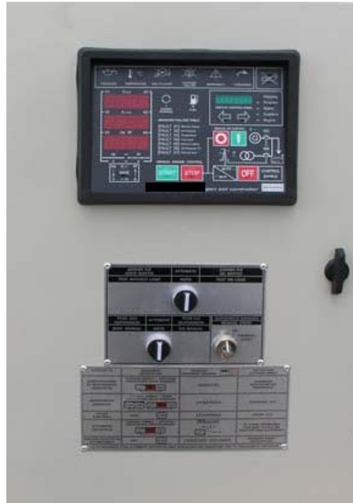
Σχ.5.4.γ Κεντρική μονάδα ελέγχου Η/Ζ
