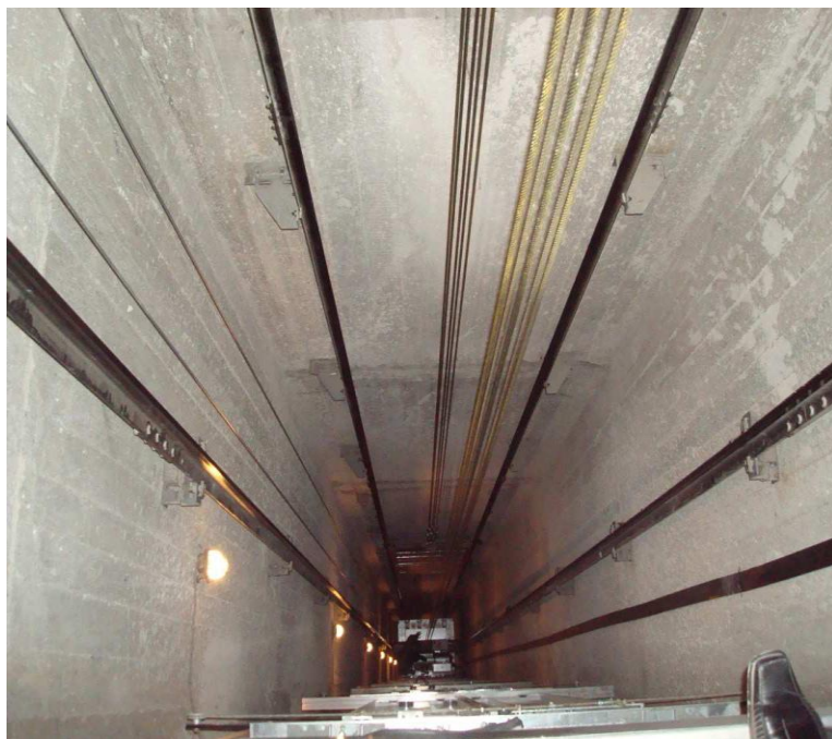
Εικόνα 1 Φρεάτιο με Οδηγούς και Συρματόσχοινα
