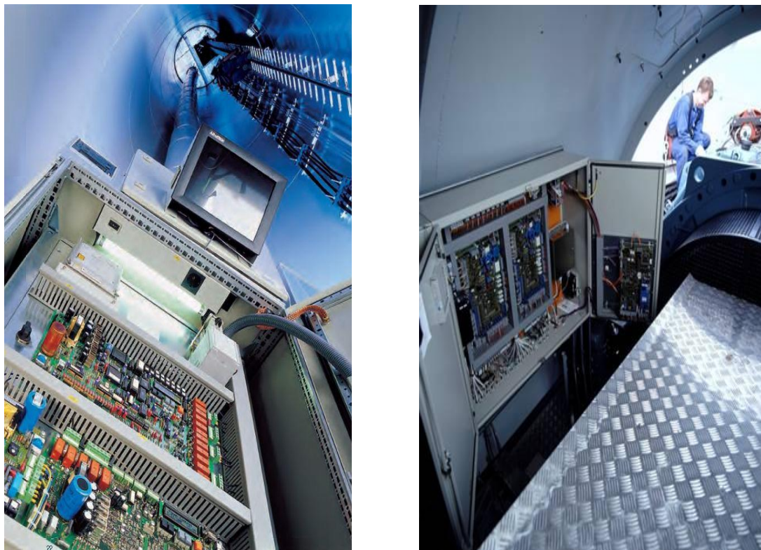
Σχήμα 10.24 Πίνακες ελέγχου ανεμογεννητριών τοποθετημένοι στη βάση (αριστερά) και στην άτρακτο (δεξιά).
