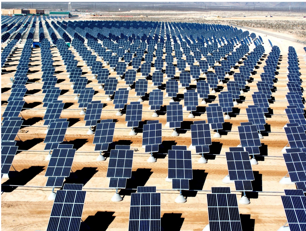
Εικόνα 1.5. Φωτοβολταϊκό πάρκο στη Νεβάδα των ΗΠΑ.
