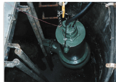
Εικόνα 4.2 αντλία λυμάτων σε φρεάτιο λυμάτων
