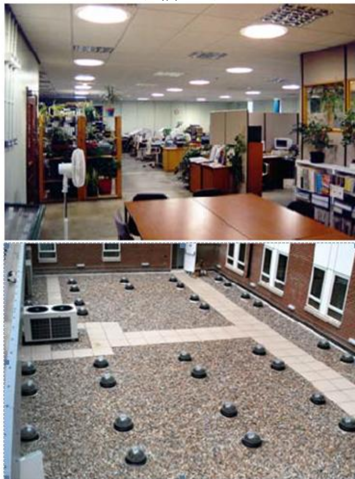
Σχήμα 3.27 Παραδείγματα χρήσης φωτοσωλήνων σε κτίρια ([Πηγή: Εταιρεία MIPECO www.mipeco.gr ])
