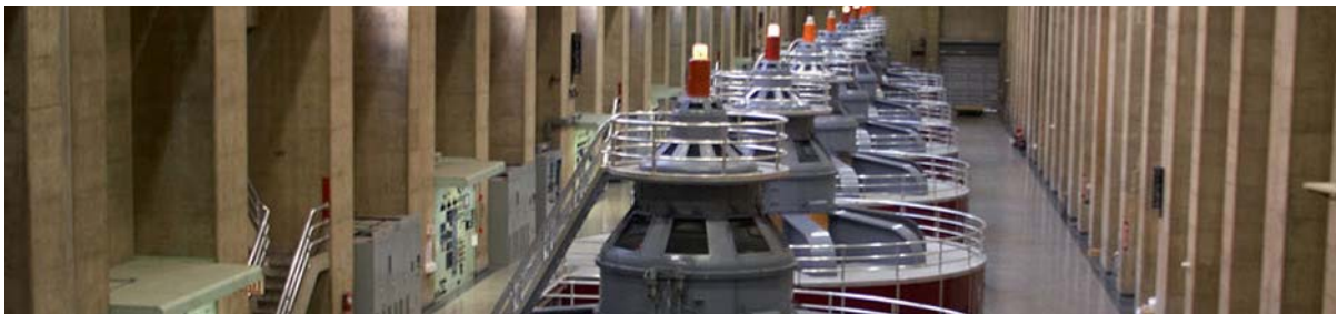
Σχήμα 2.17 Εσωτερικό κτιρίου από μετόν, που στεγάζει τον Η/Μ εξοπλισμό.
