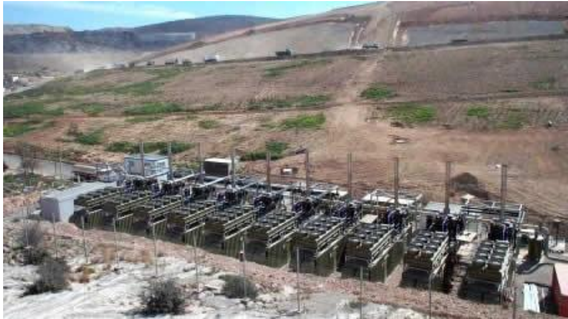
Εικόνα 8 Container μονάδων γεννητριών
