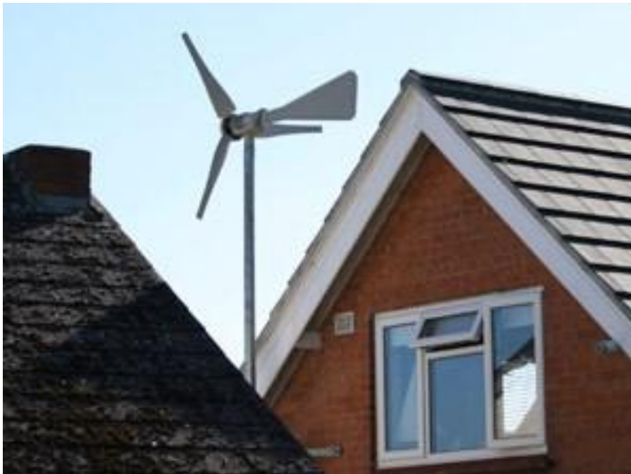
Εικ. 9. Ανεμογεννήτρια σε κατοικία.
