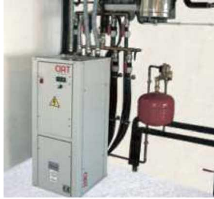
Εικ. 12.Γεωθερμική αντλία θερμότητας σε κτίριο.
