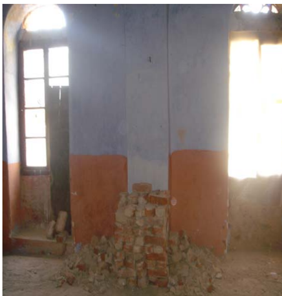
Εικ. 53 : Τα παράθυρα στο δωμάτιο του ορόφου στην δυτική όψη. Πηγή :Ιδία επεξεργασία.
