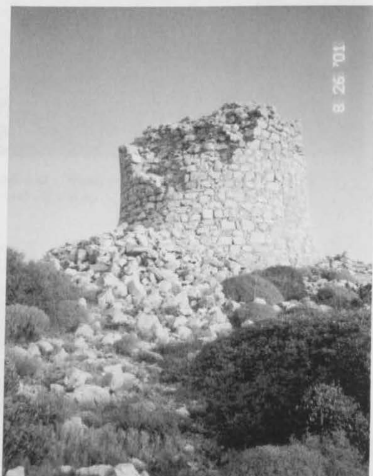
Εικόνα 60 : Ανατολική όψη της βίγλας. Η πλευρά εμφανίζει τις περισσότερες βλάβες.
