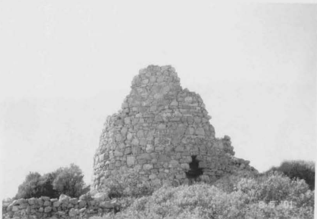
Εικόνα 69 : Σε πιο καλή κατάσταση βρίσκεται η ανατολική πλευρά της βίγλας, αν και σε αυτή εμφανίζονται ρωγμές.
