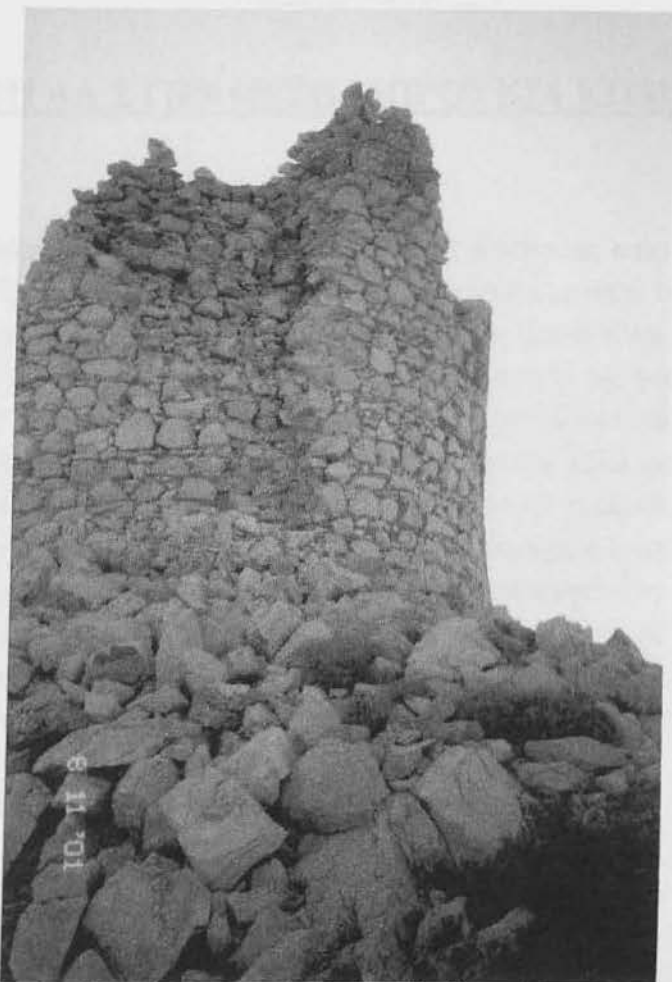
Εικόνα 28 : Βορειοανατολική πλευρά , διακρίνεται η κατάρρευση του τοιχώματος της βίγλας.
