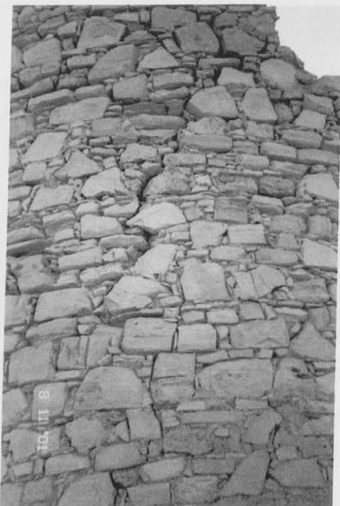
Εικόνα 37 : Διακρίνονται ρωγμές στα τοιχώματα, πιθανών από σεισμούς.
